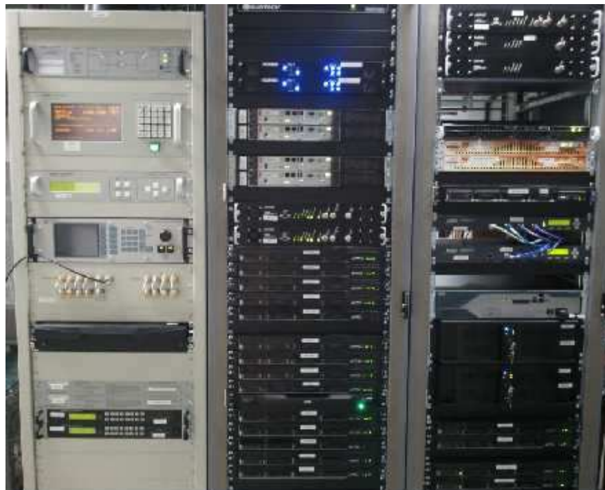
Figura 3. 8 Equipos del NOC
