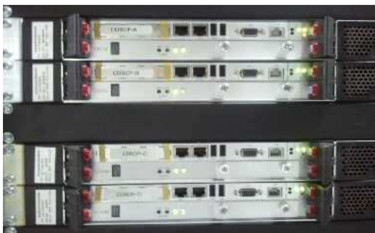
Figura 3. 9 Demoduladores CDS existentes en HUB
