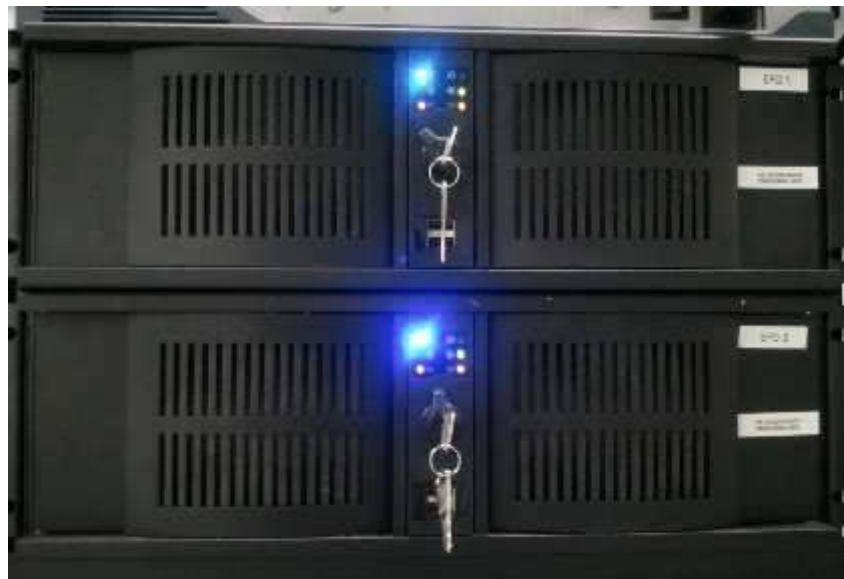
Figura 3. 19 Servidores EPD en el NOC
