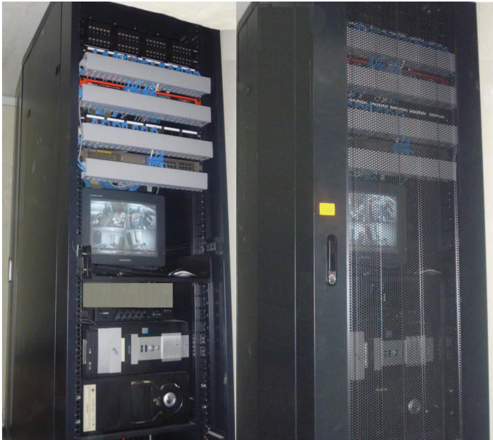
Figura 3. 18 Vista del rack implementado en la Oficina Principal
