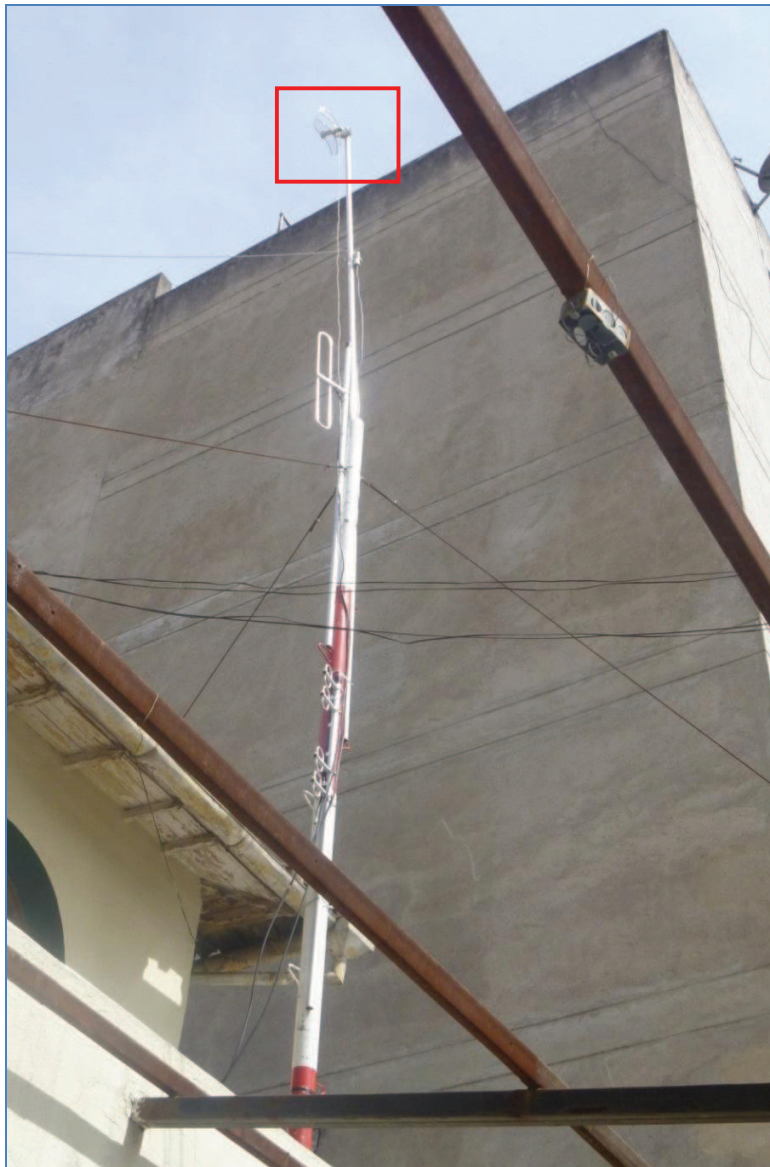
Figura 3. 4 Vista de antena en la Oficina Principal
