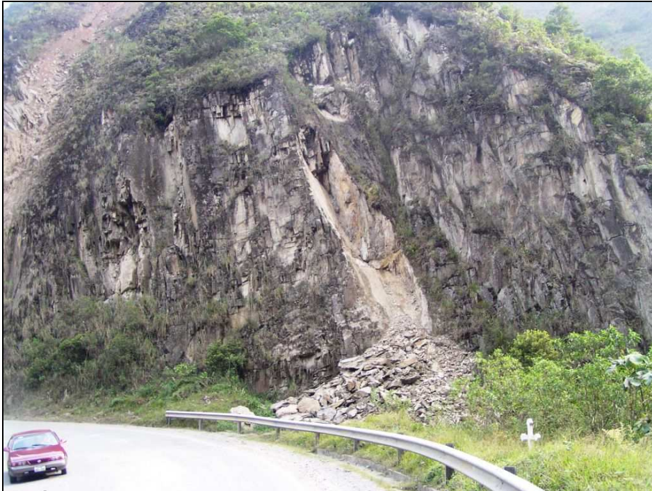
FOTOGRAFÍA 4.1. Deslizamiento en cuña. Unidad Chiguinda. Vista SO (UTM: 713074-9561087)
