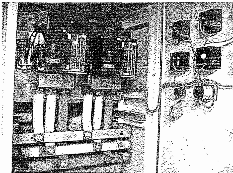
Gráf. 13. Fotografía del tablero de transferencia automática.
