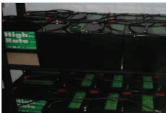
Figura 2.7 Banco de baterías del nodo Gosseal
