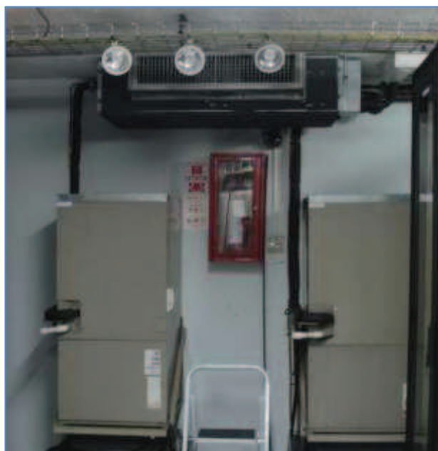
Figura 2.8 Aire acondicionado del nodo Gosseal
