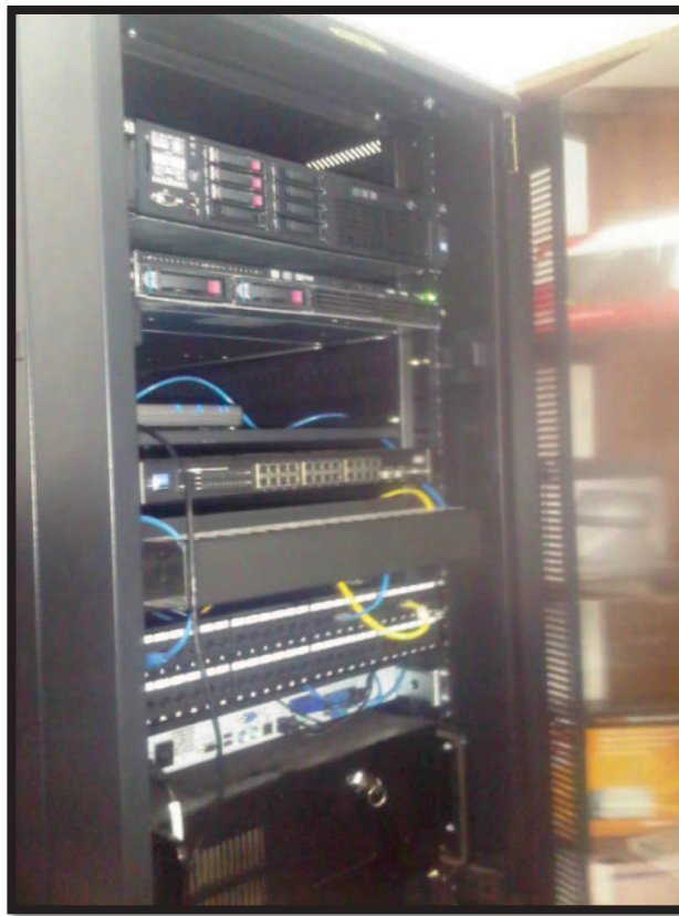
Figura 2.35 Elementos activos y pasivos ubicados en el rack de la sala de equipos
