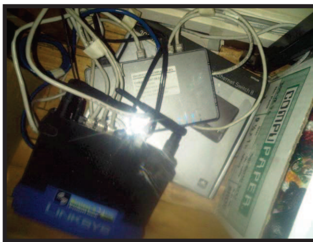
Figura 2.21 Router Linksys y switch 3com de 8 puertos oficina Colecturía
