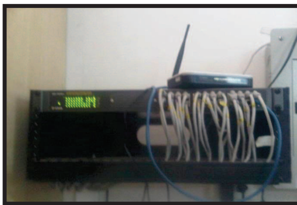
Figura 2.33 Switch D-LINK y Router TP-LINK del laboratorio de informática
