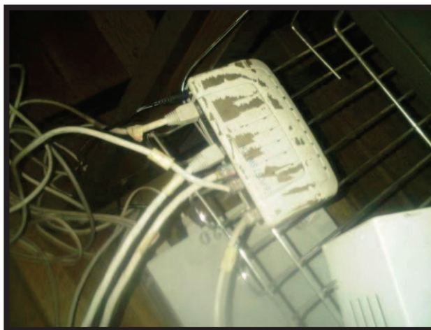
Figura 2.31 Switch genérico de 8 puertos en la Biblioteca
