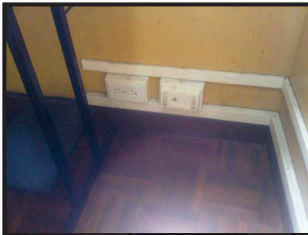
Figura 2.38 Canalización con canaletas plásticas decorativas – Lab. de Informática
