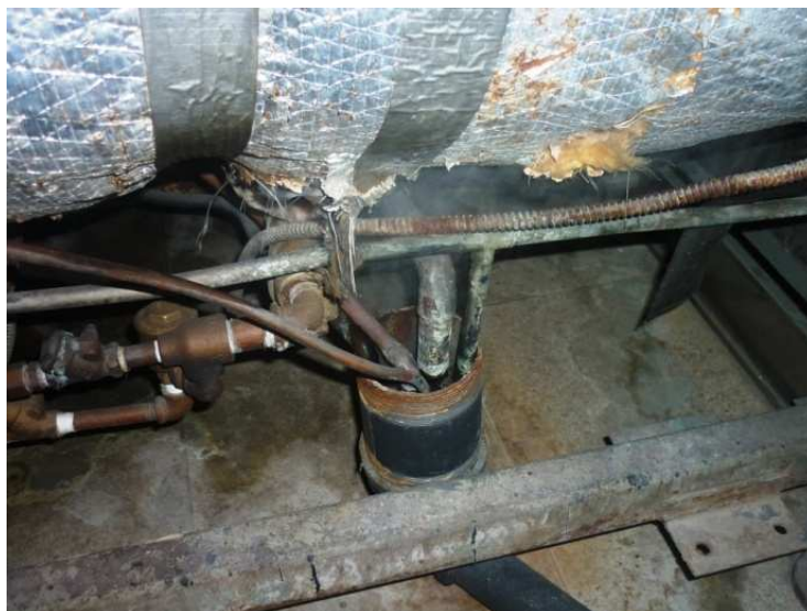
Figura 2.7. Retorno de condensado esterilizador AMSCO.
