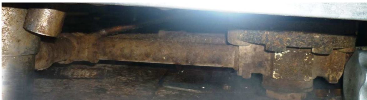
Figura 2.17. Fugas de vapor y corrosión de las tuberías (Marmita)
