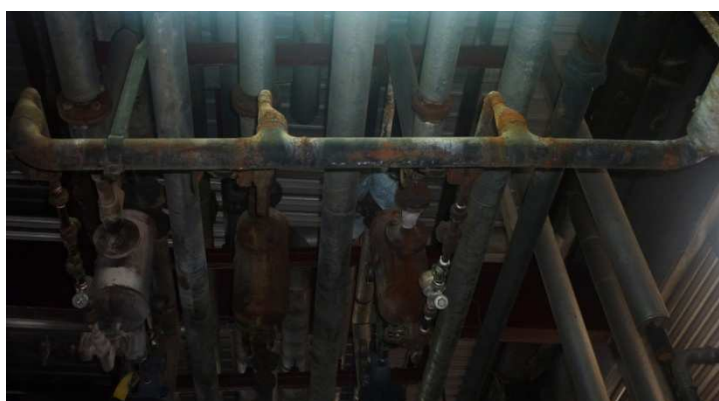
Figura 2.23. Tuberías sin y con aislante deteriorado
