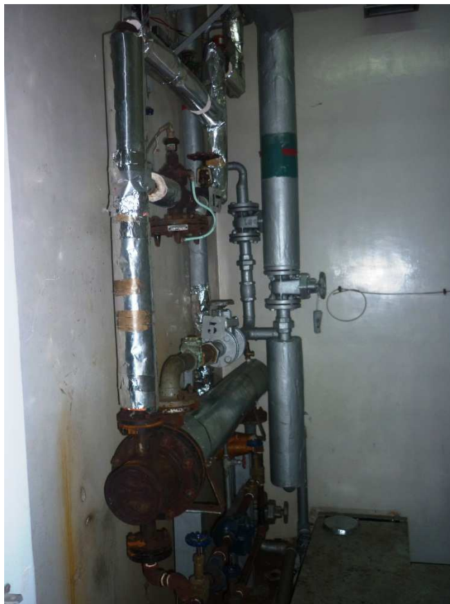
Figura 2.18. Sistema de calentamiento de la piscina
