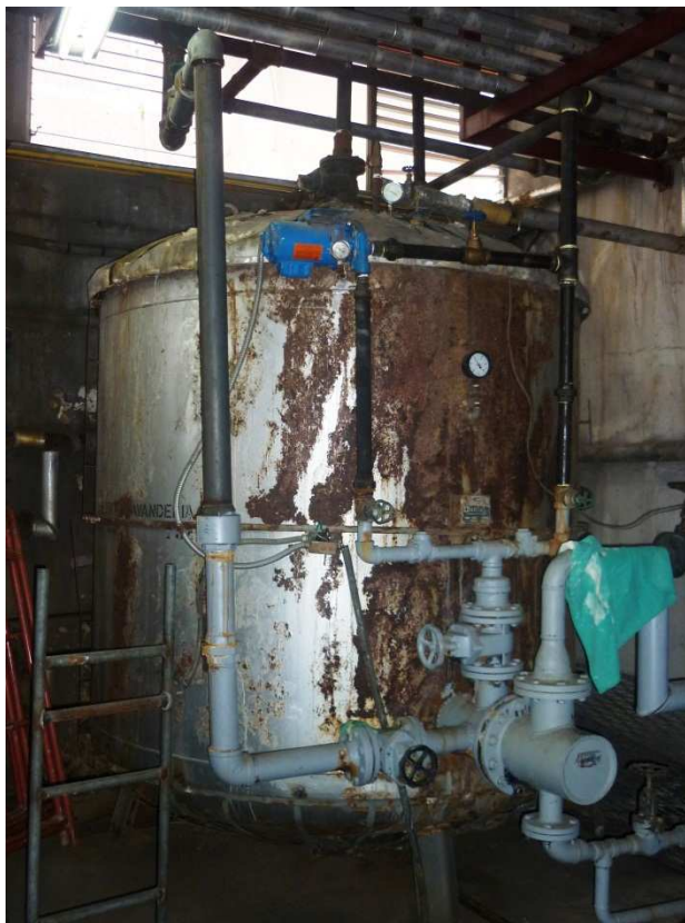
Figura 2.20. Tanque de abastecimiento lavandería
