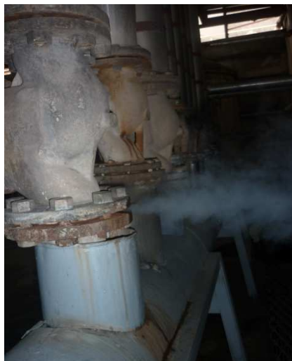
Figura 2.4. Válvula de entrada al distribuidor de vapor.
