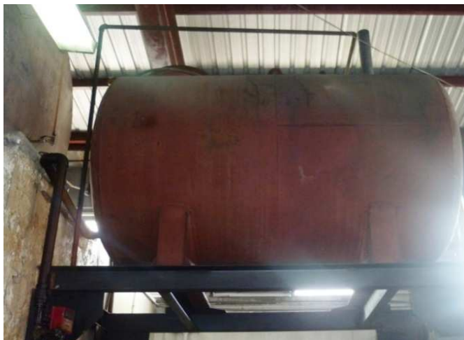
Figura 2.29. Tanque de almacenamiento de combustible
