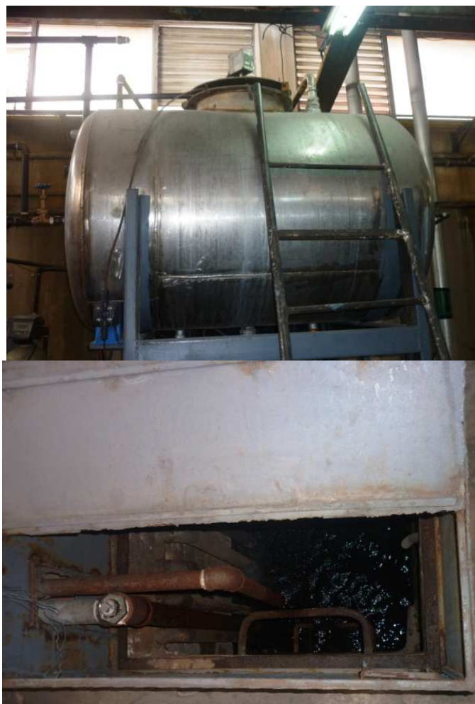
Figura 2.21. Tanque de condensado
