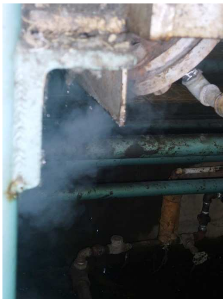
Figura 2.15. Fuga de vapor tuberías internas del rodillo planchador
