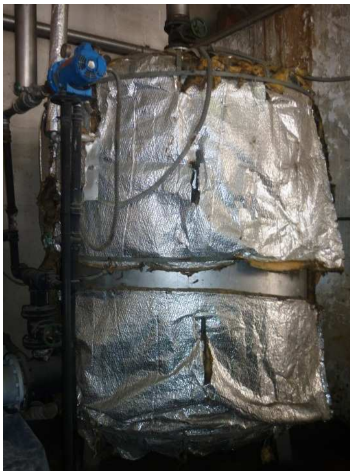
Figura 2.19. Tanque de abastecimiento sanitario
