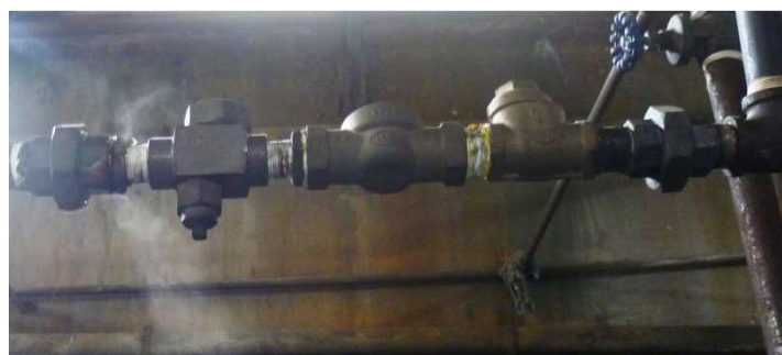
Figura 2.24. Corrosión en juntas y uniones
