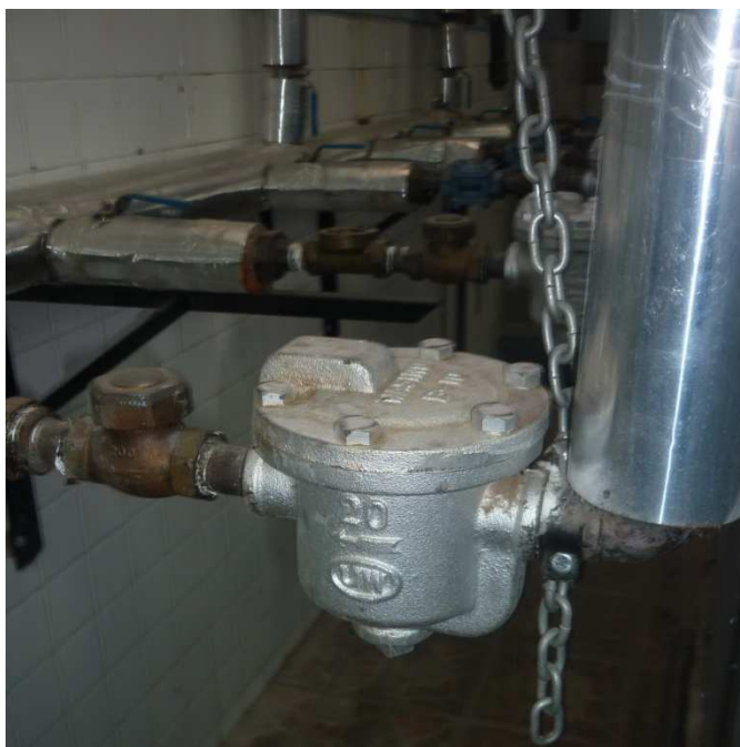
Figura 2.28. Trampa de vapor de balde invertido
