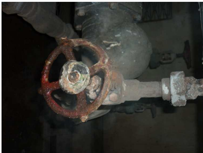
Figura 2.25. Corrosión en válvulas
