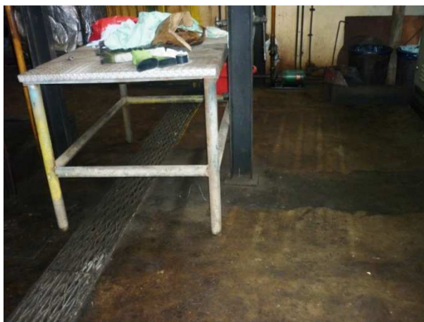
Figura 2.31. Piso por debajo del tanque de almacenamiento
