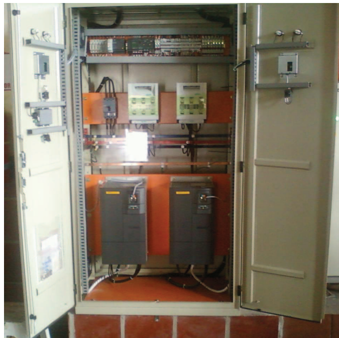
Figura 2.33. Vista interior del tablero de control
