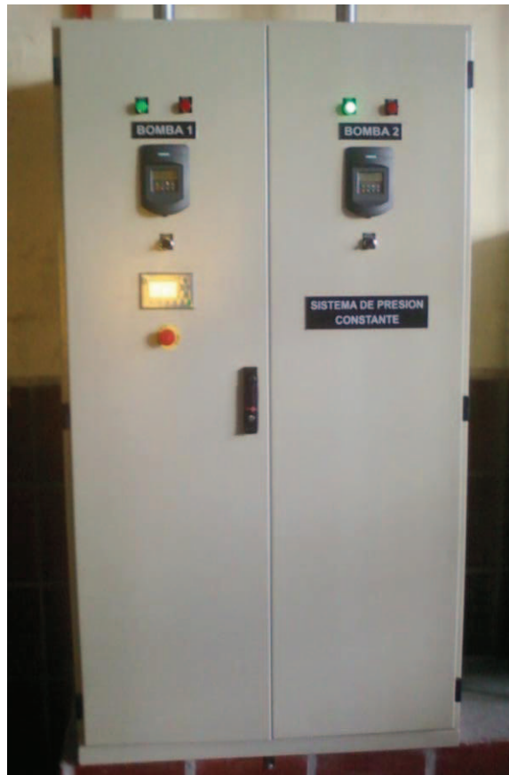
Figura 2.32. Vista exterior del tablero de control
