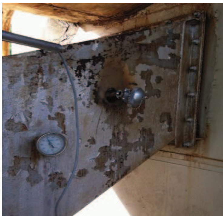
Figura 4-7 Instalación del Sensor RTD Pt100
