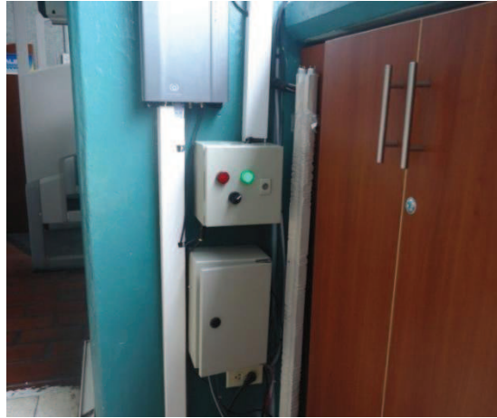
Figura 4.10 Ubicación del tablero TCA
