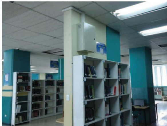
Figura 4.11 Ubicación tablero TCB
