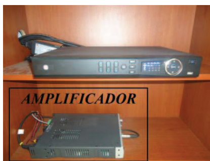
Figura 4.24 Ubicación del amplificador en el armario de la oficina de la administración
