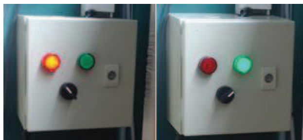
Figura 4.13 Luces piloto encendidas para los modos manual y automático/distancia respectivamente
