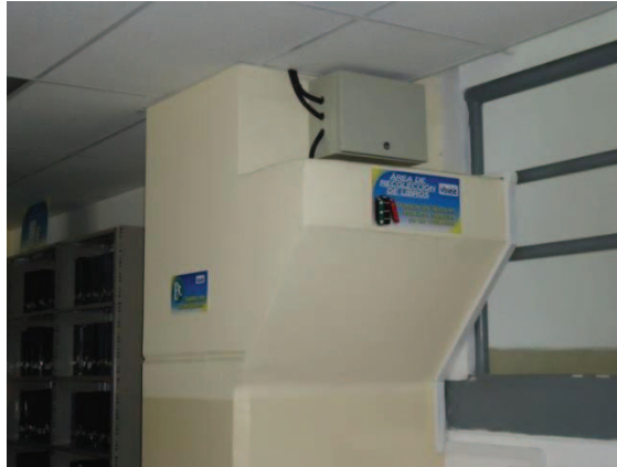
Figura 4.12 Ubicación del tablero TCC
