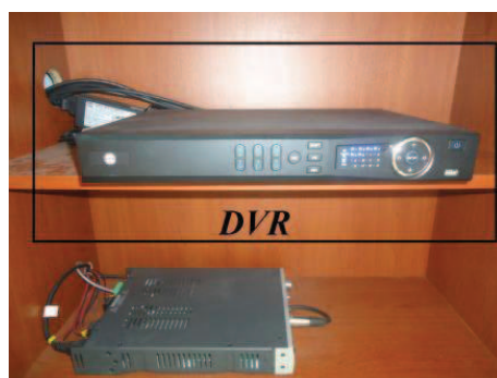
Figura 4.21 Ubicación del DVR en el armario de la oficina de la administración
