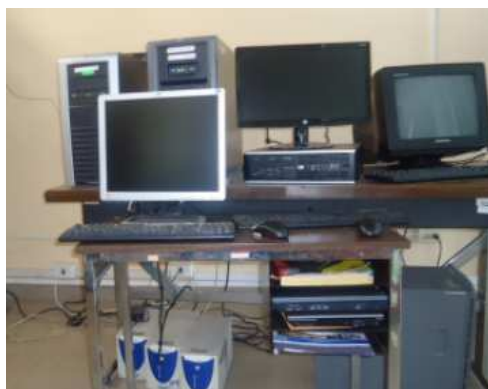
Figura N° 2.14 Cuarto de equipos
