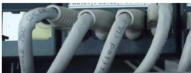
Figura N° 2.8 Cables de red con curvas erróneas
