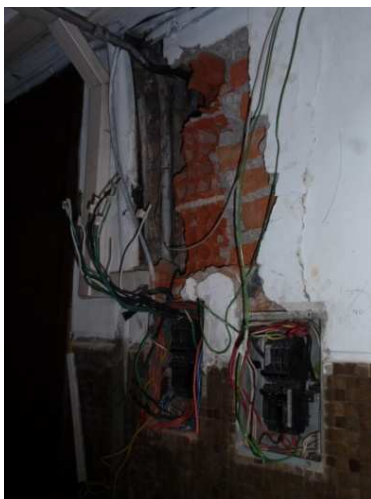
Figura N° 2.48 Acometida del 5to Piso
