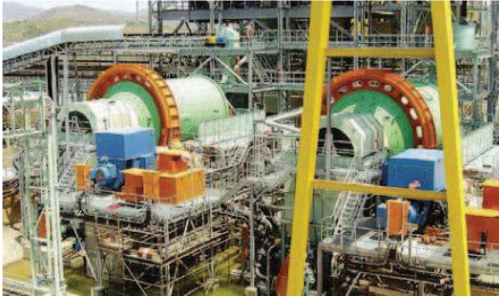
Figura 3.21. Aplicación: molino de bolas. 2 motores de inducción de rotor bobinado MAF800, 4.600 kW, 11.000 V, 6 polos
