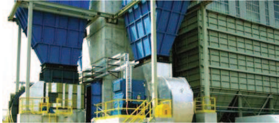
Figura 3.27. Aplicación: extractores de aire. Motor de inducción MGP8010, 900 kW, 4.160 V, 8 polos
