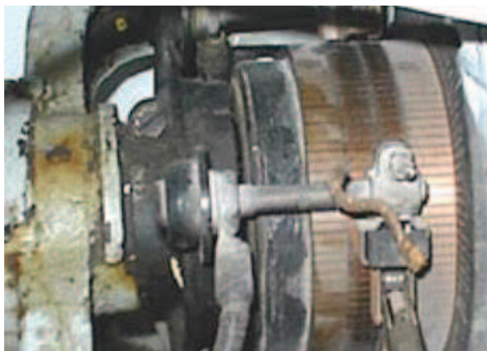
Figura 1.15. Reconocimiento motor c.c. Colector, escobilla y porta escobilla en motor c.c.
