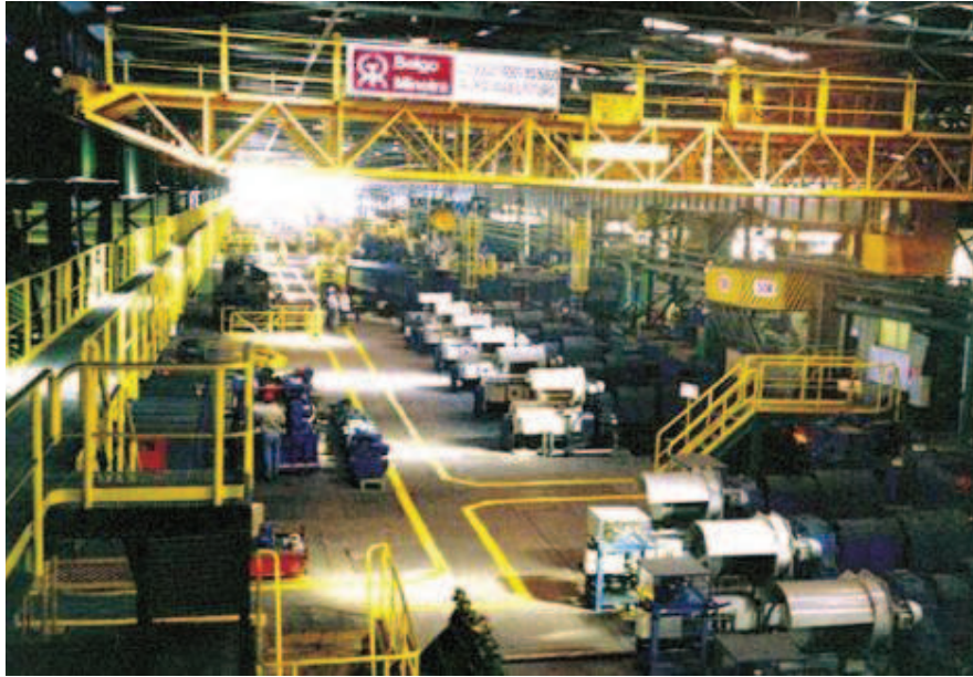
Figura 1.21. Aplicación: laminación. 5 motores de corriente continua, 750 kW; 14 motores de corriente continua, 400 kW; 5 motores de corriente continua, 100 kW; 5 motores de corriente continua, 55 kW; 3 motores de corriente continua, 23 kW.5
