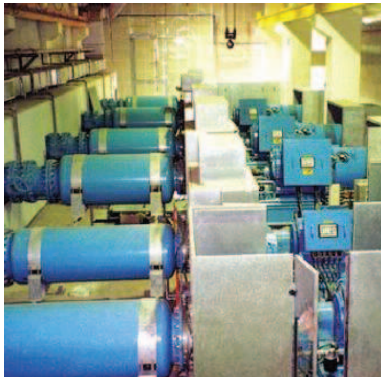
Figura 3.20. Aplicación: sopladores para aire. 4 motores de inducción HGF450, 630 kW, 6.600 V, 2 polos.
