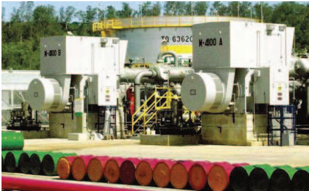
Figura 2.15. Aplicación: compresores recíprocos: 2 motores síncronos 3.600 kW, 13.200 V, 6 polos
