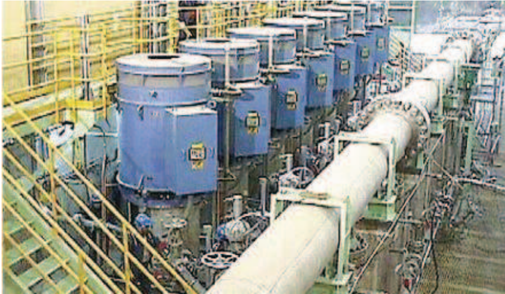
Figura 3.19. Aplicación: bombas. 7 motores de inducción MGF8809, 1.267 HP, 4.160 V, 2 polos
