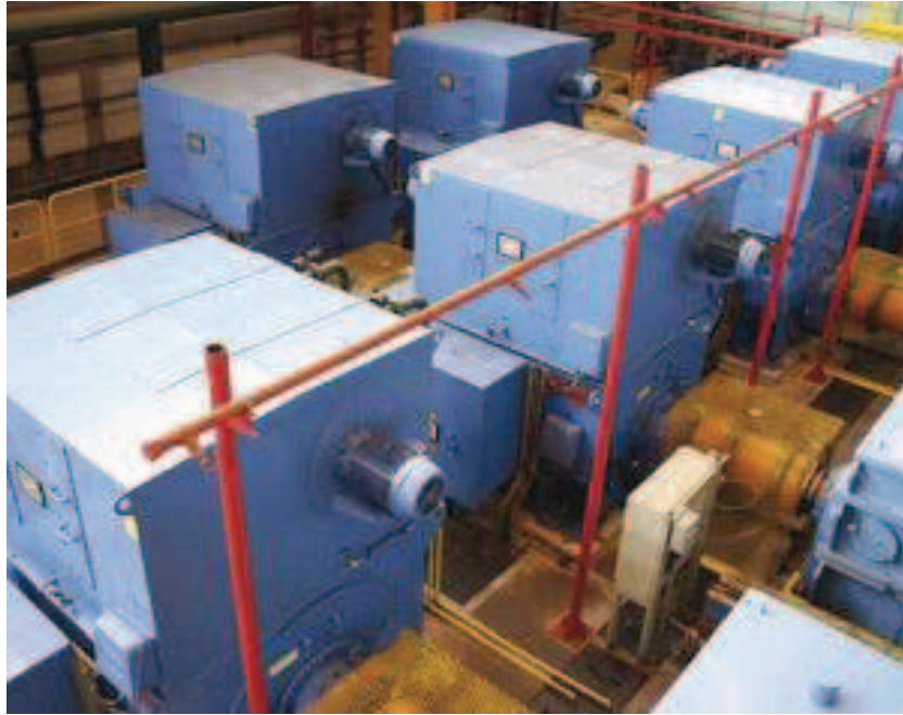
Figura 2.17. Aplicación: laminación siderúrgica. Motores Síncronos SDL800, 3.000 kW, 3.100 V
