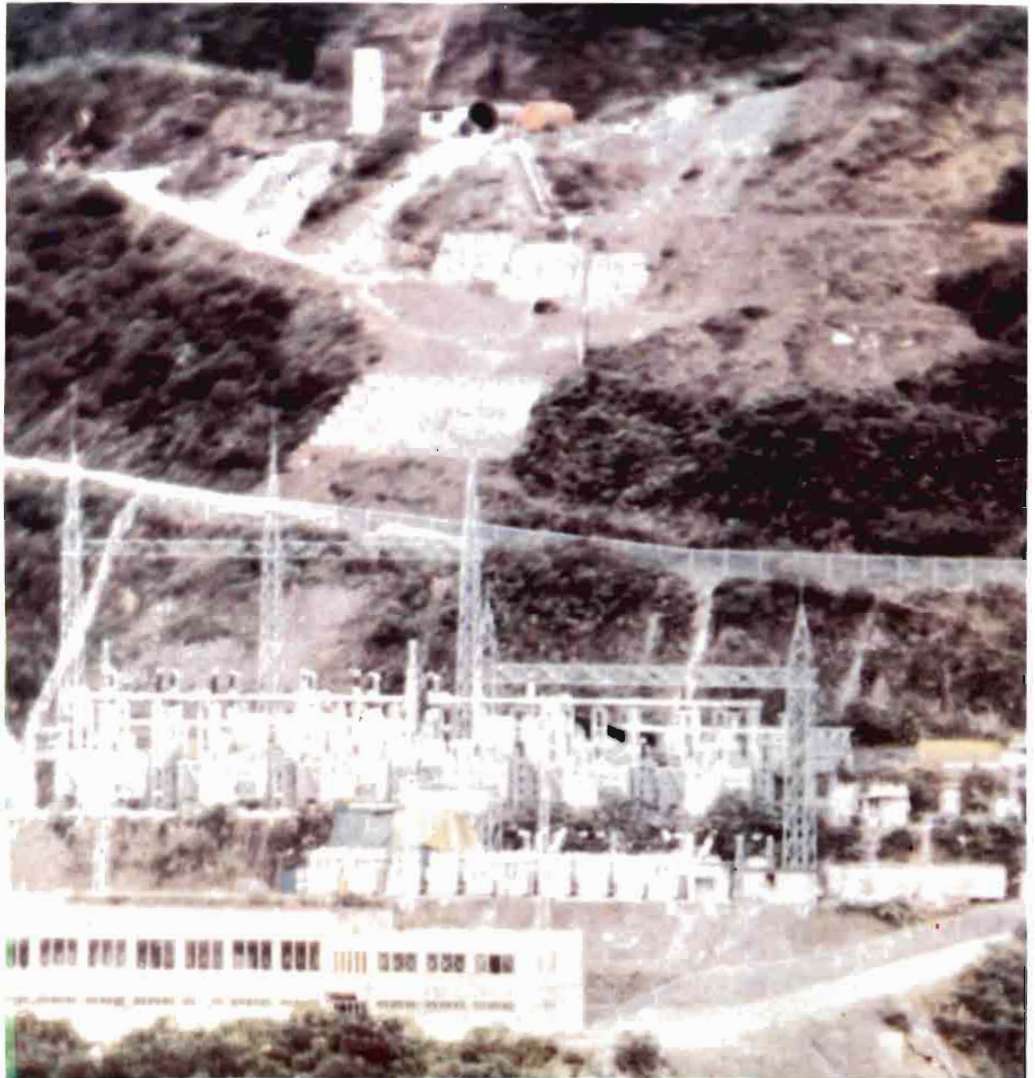
Salida de líneas de transmisión desde el proyecto Paute
