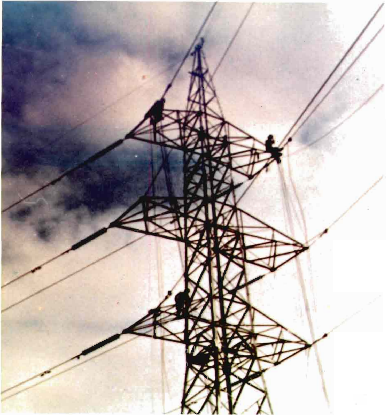
L/T Paute-Guayaquil. Tendido de conductores
