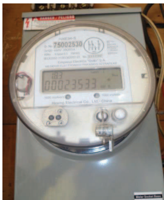
Figura1.6 Anexo 1 Contador de Energía electrónico trifásico 4 hilos
