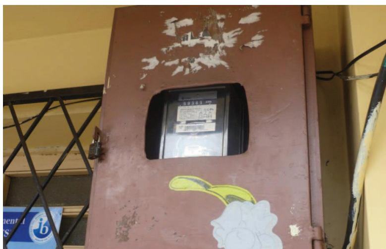
Figura 1.10 Anexo 1 Contador de Energía electromecánico Bifásico3 hilos
