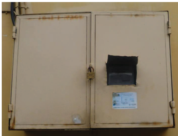
Figura 1.3 Anexo 1 Contador de Energía electromecánico bifásico 3 hilos
