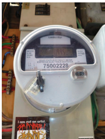
Figura 1.8 Anexo 1 Contador de Energía trifásico 4 hilos
