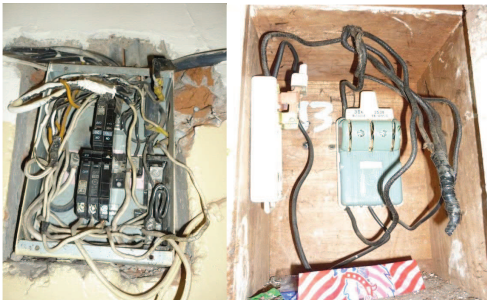
Figura 2.16 Estado deteriorado de las Instalaciones actuales
