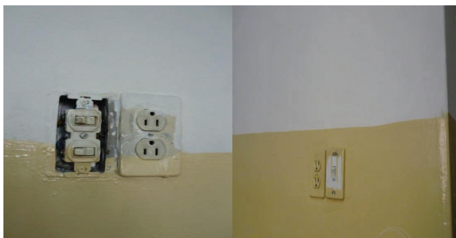
Figura 2.5. Ejemplos de tomacorrientes en el edificio
