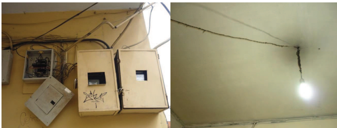
Figura 2.17 Estado deteriorado de las Instalaciones actuales
