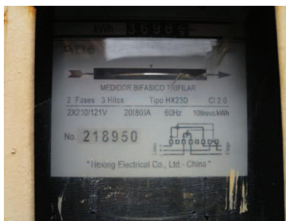
Figura 1.9 Anexo 1 Contador de Energía electromecánico Bifásico 3 hilos
