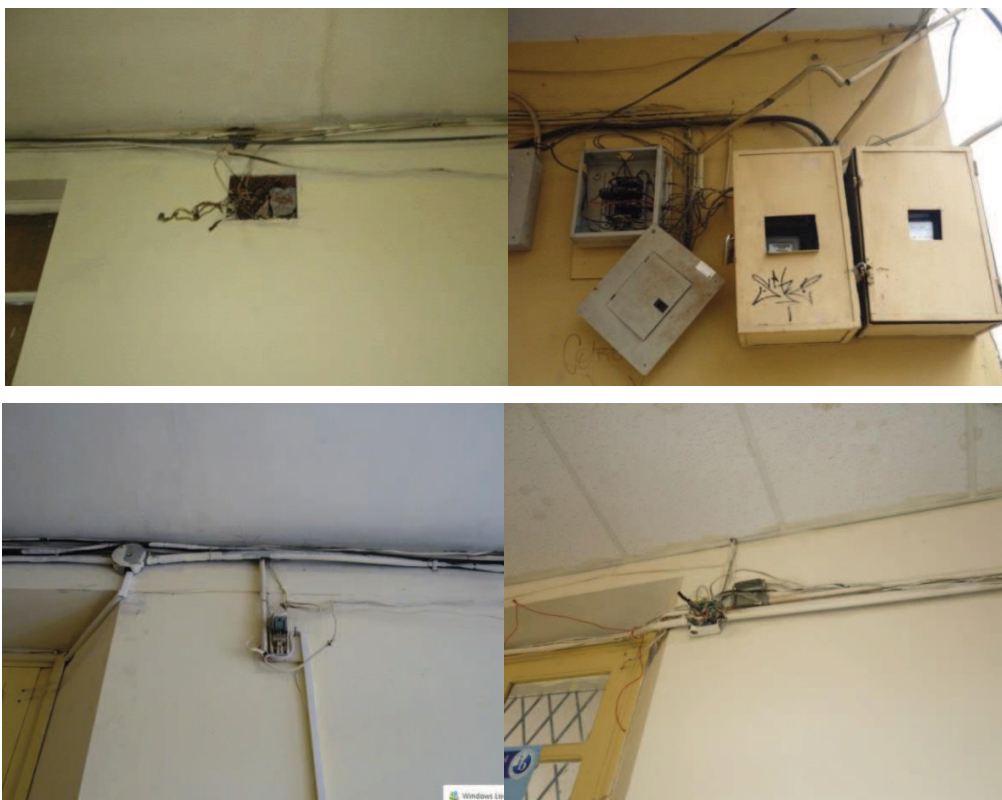
Figura 2.14 y 2.15 Ejemplo de las instalaciones Eléctricas deterioradas de los Edificios
