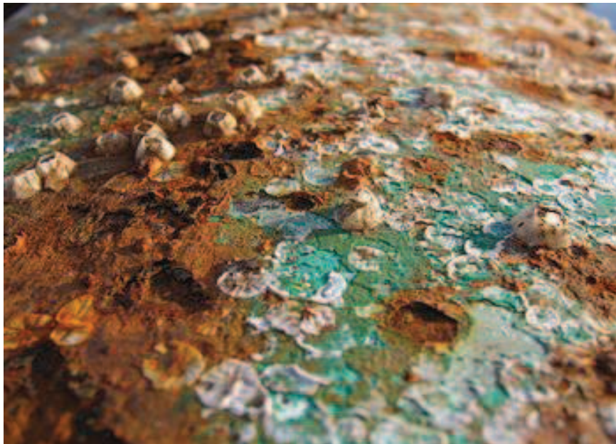
FIG 37 DESGASTE POR CORROSIÓN
