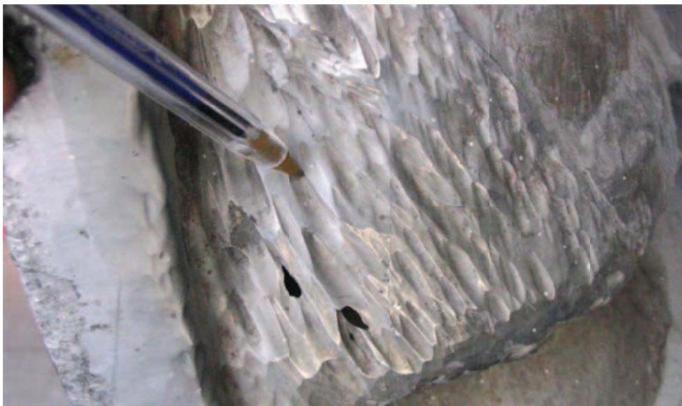
FIG 35 DESGASTE POR CAVITACION EN LAS PAREDES DE UNA BOMBA DE AGUA
