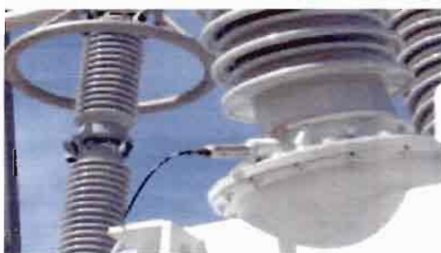
Figura 4.17: Sensor -adaptador instalado en el bushing del transformador.
