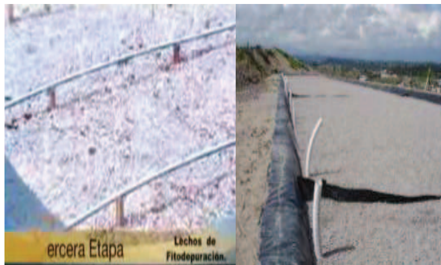
Figura 1.15. Vista panorámica de las instalaciones del tratamiento de lixiviado en el relleno sanitario “El Inga” - Lechos de Fitodepuración (Tercera etapa) (Gasgreen, 2010)
