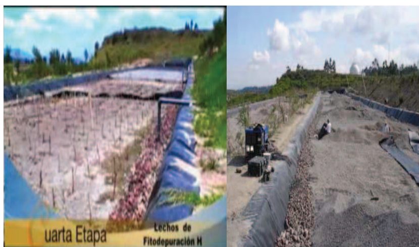
Figura 1.16. Vista panorámica de las instalaciones del tratamiento de lixiviado en el relleno sanitario “El Inga” - Lechos de Fitodepuración Horizontal (Cuarta etapa) (Gasgreen, 2010)
