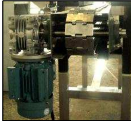
Fig. 2.11. Datos de placa y fotografía del motorreductor
