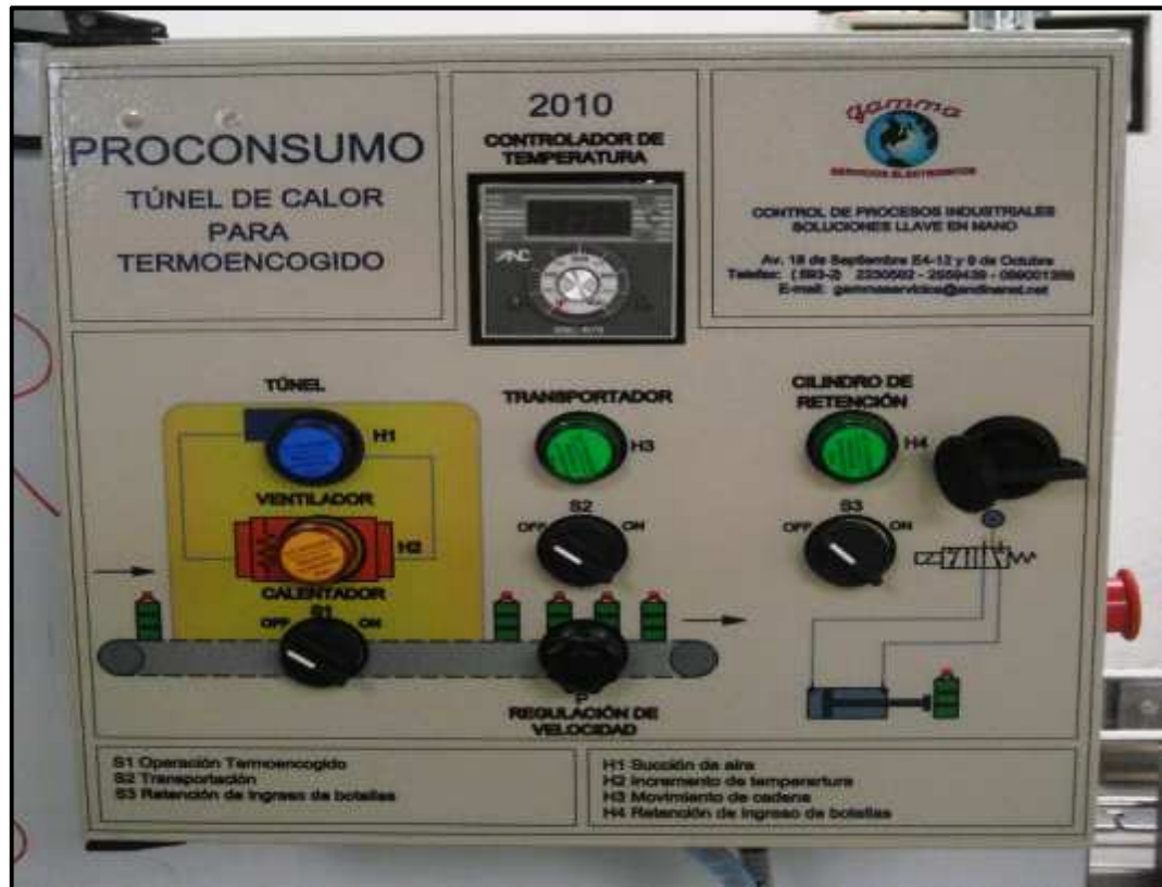
Fig. 2.28 Tablero de fuerza y control
