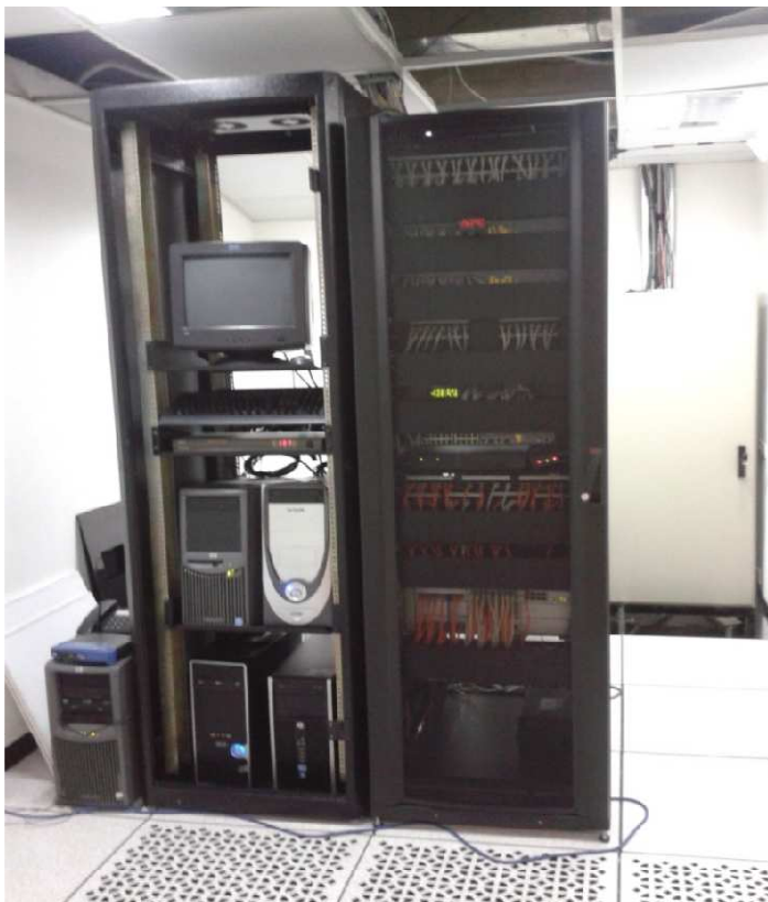
Figura 2- 1: Cuarto de Equipos
