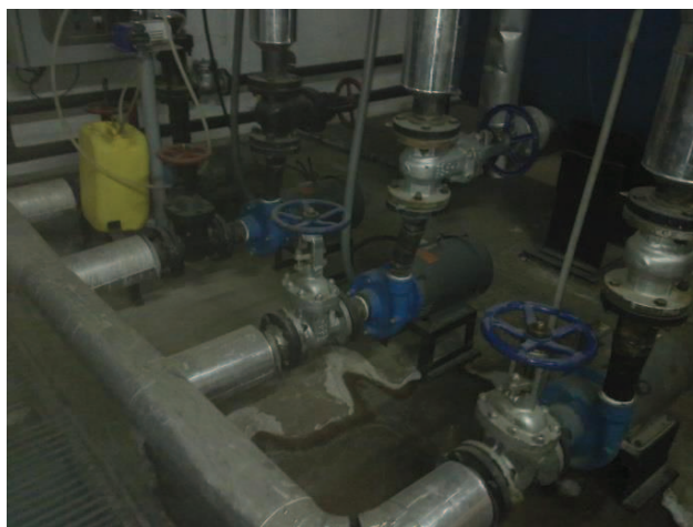
Figura.5.5. Bombas de agua.
