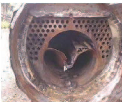
Figura.1.7. Corrosión de un caldero.
