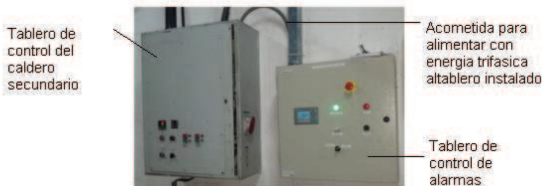
Figura. 9.5. Tablero que abastece de energía al tablero de control de alarmas.
