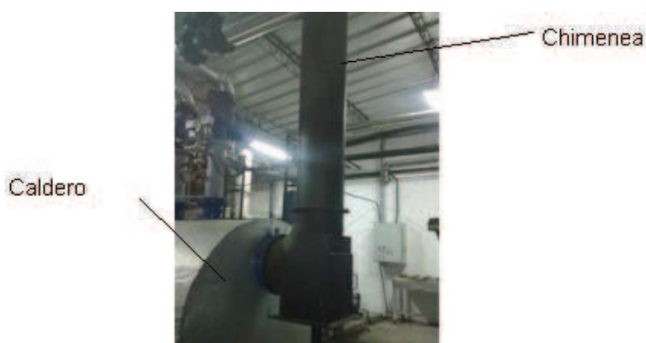
Figura.5.3. Chimenea del caldero principal.
