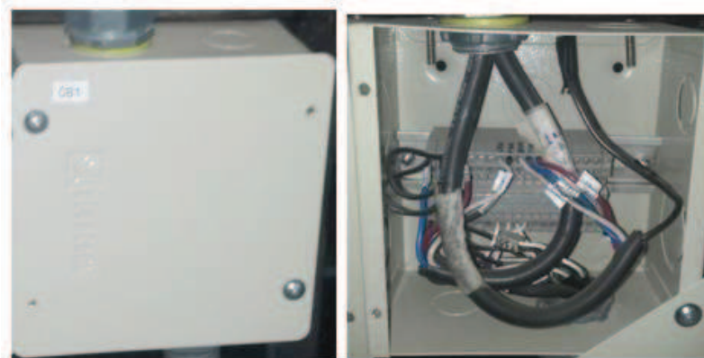
Figura.10.2. Cajas de revisión y conexión de los elementos sensores.
