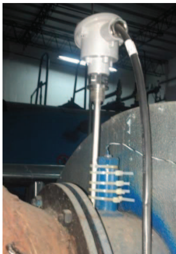
Figura. 8.6. PT100 implementado en la chimenea del caldero principal.
