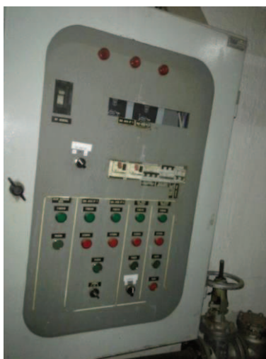
Figura .6.3. Tablero de control de encendido de las bombas de agua.
