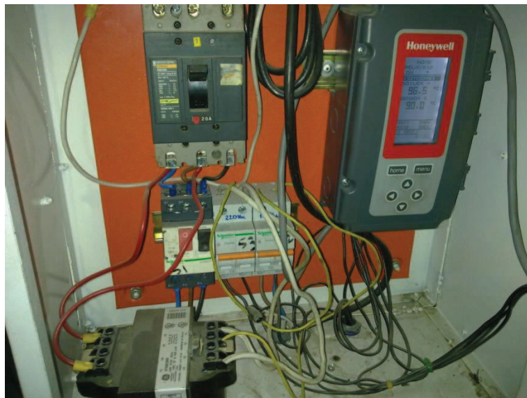
Figura.6.4. Tablero de control de encendido y apagado del quemador.
