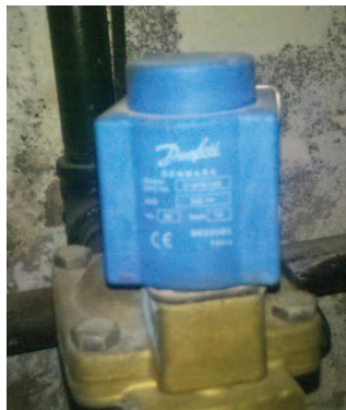
Figura. 15.6. Electroválvula en serie con la bomba de agua del tanque de expansión.
