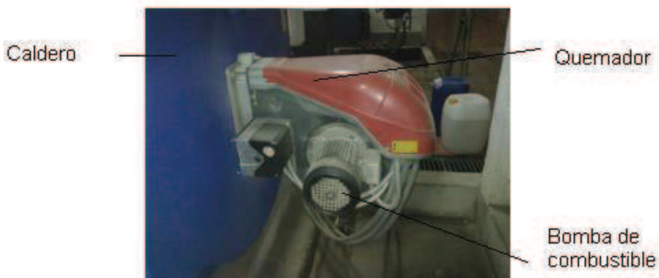
Figura. 15.2. Quemador del caldero.
