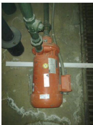
Figura.5.6. Bomba del tanque de expansión.
