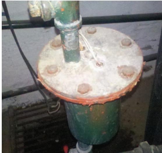
Figura. 15.7. Sensor de nivel del tanque de expansión.
