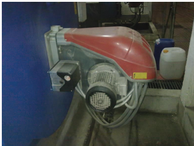
Figura.6.2. Quemador del caldero principal.
