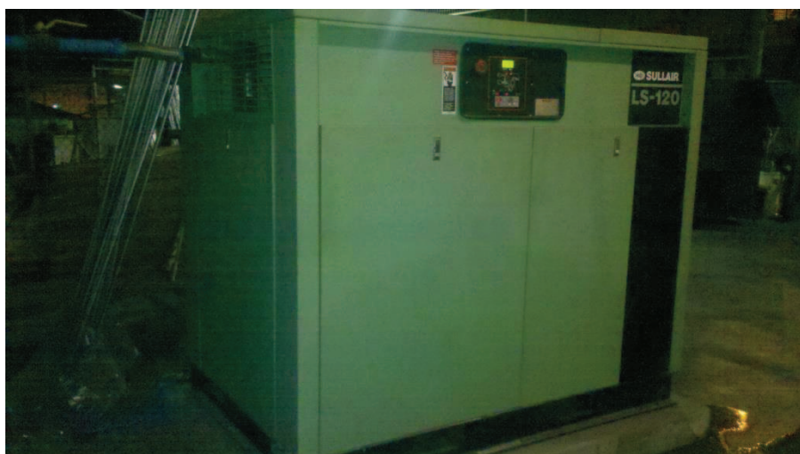
Figura.6.5. Compresor que abastece al tanque de expansión.
