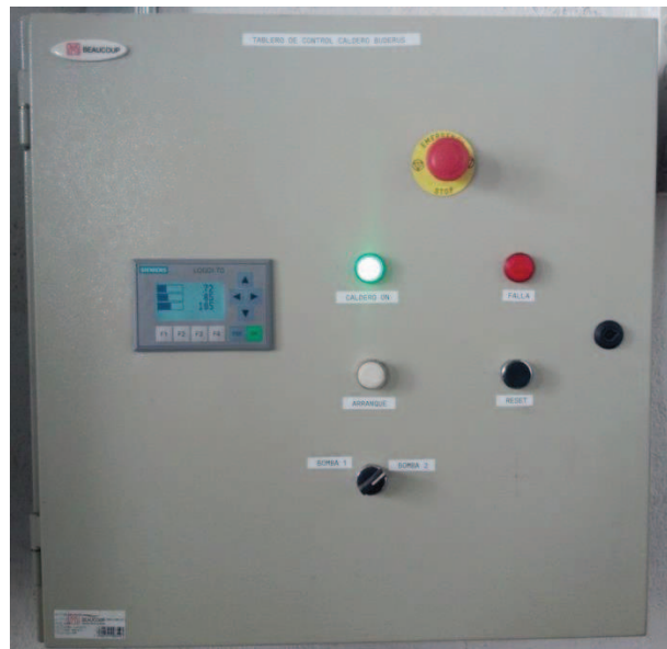
Figura. 17.2. Tablero implementado y programado. Fuente: Propia.
