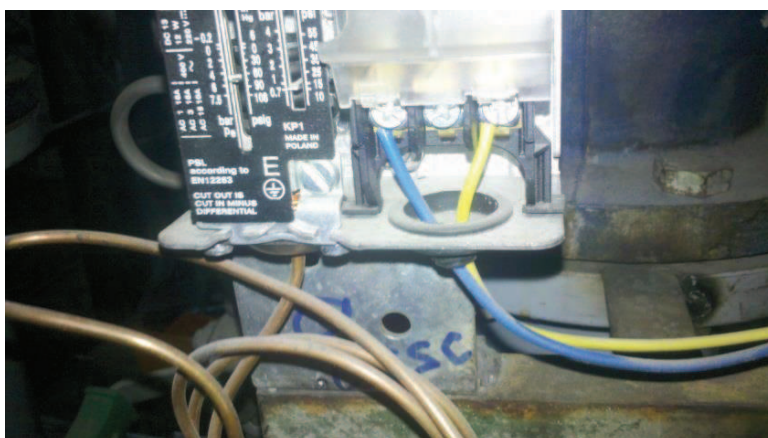
Figura. 14.9. Instalación del presos tato de máxima presión.
