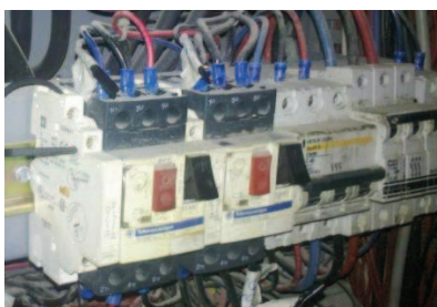
Figura. 15.4. Guarda motores térmicos de las bombas de agua.
