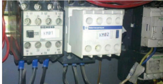
Figura. 15.5. Contactores de las bombas de agua.
