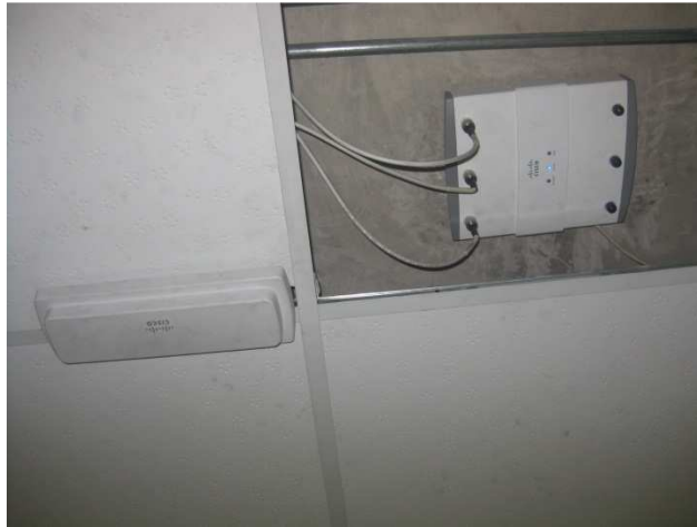
Figura 2.2: Access Point colocado en la losa.
