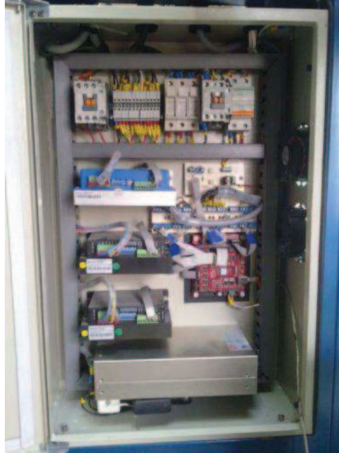
Figura 3.77 Tablero de control final.
