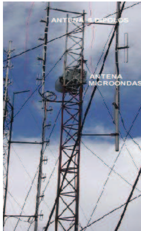
Figura 4.2.- Antena de 8 dipolos y antena microondas de enlace. Estación Atacazo Cuchillas.
