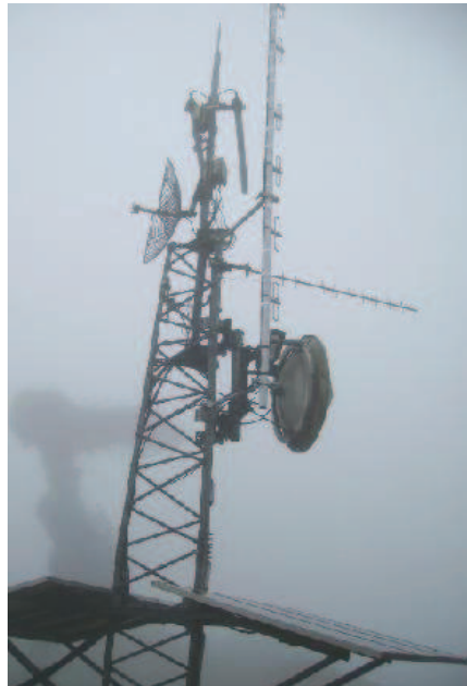
Figura 4.10.- Antena de 8 dipolos de la repetidora. Estación Loma Grande.
