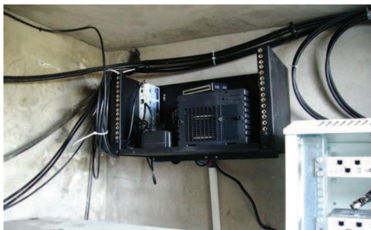
Figura 4.5.- Equipos instalados en la estación Putzalahua.
