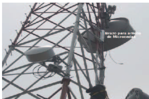
Figura 4.18.- Antena de microondas dirigida hacia Pilisurco y brazo de antena.
