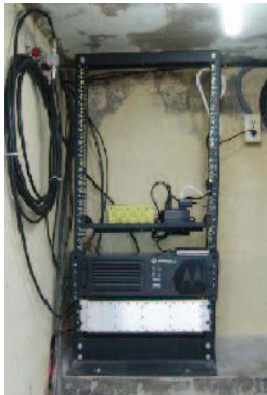
Figura 4.7.- Equipos instalados en la estación Pilisurco.
