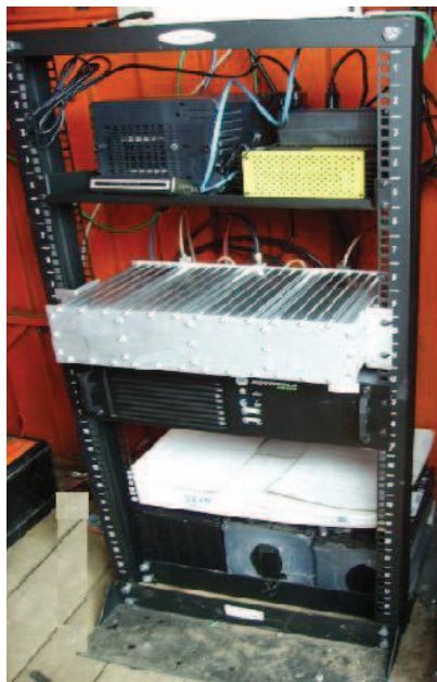
Figura 4.1.- Repetidor y enlace instalado en Atacazo Cuchillas.
