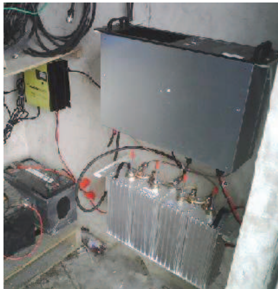
Figura 4.13.- Equipos instalados en la estación Cotacachi.
