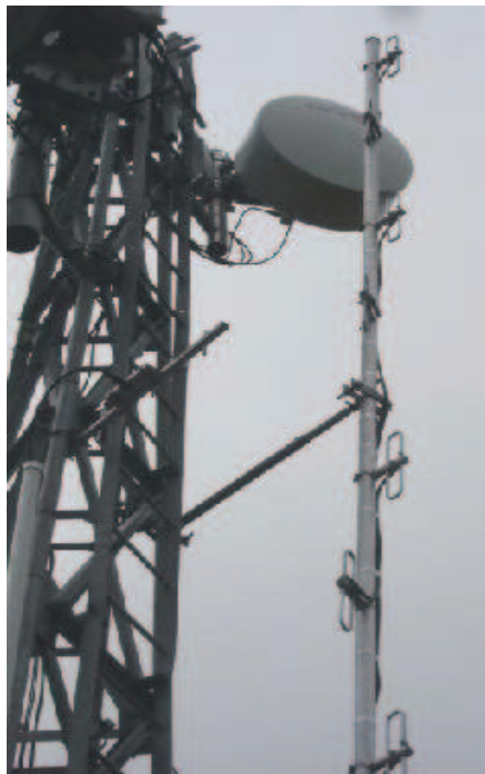
Figura 4.14.- Antena de 8 dipolos y antena de microondas dirigida hacia Cayambe.
