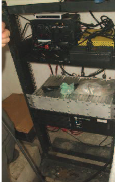
Figura 4.11.- Equipos instalados en la estación Lumbaqui.
