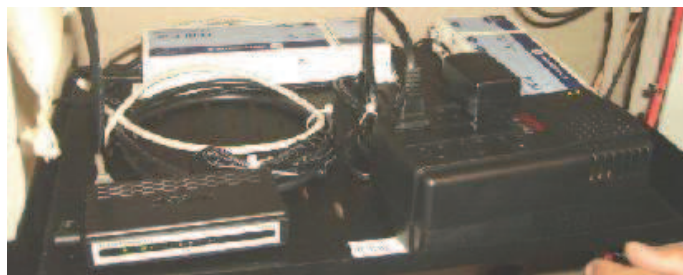
Figura 4.17.- Equipos instalados en la estación Capadia.
