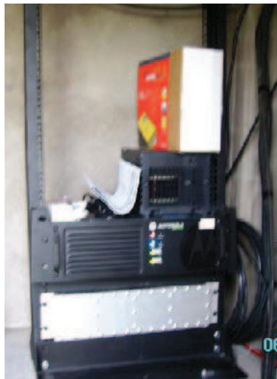
Figura 4.9.- Equipos instalados en Loma Grande.
