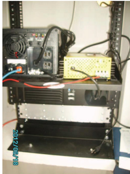
Figura 4.16.- Equipos instalados en la estación Cerro B – 507.
