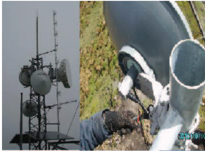
Figura 4.8.- Antena de 8 dipolos y del enlace hacia Capadia.
