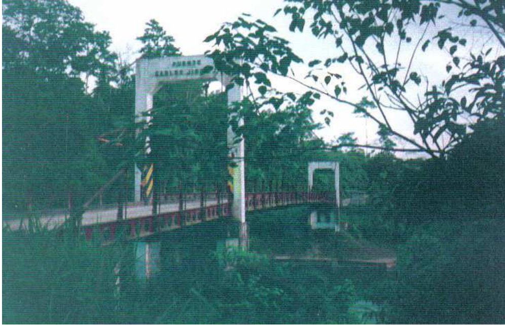
FOTOGRAFÍA Nº 15 LATERAL DERECHA DEL PUENTE DE TRAMO RÍO km 19 EL ESFUERZO SOBRE EL RÍO BABA
