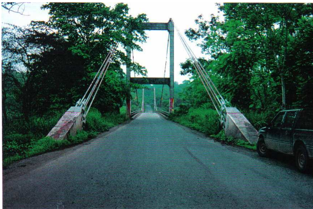
FOTOGRAFÍA N° 7 FRONTAL DEL PUENTE DE TRAMO SAN MATEO-TACHINA SOBRE EL RÍO SAN MATEO
