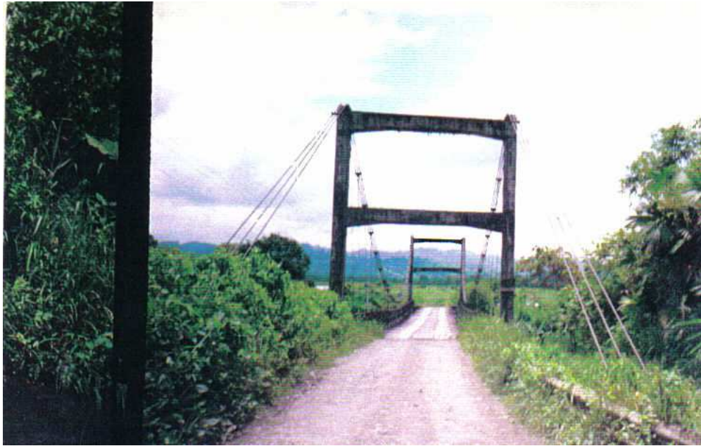
FOTOGRAFÍA Nº 19 FRONTAL DEL PUENTE DE TRAMO PATRICIA- COOP. 14 DE ABRIL SOBRE EL RÍO BABA
