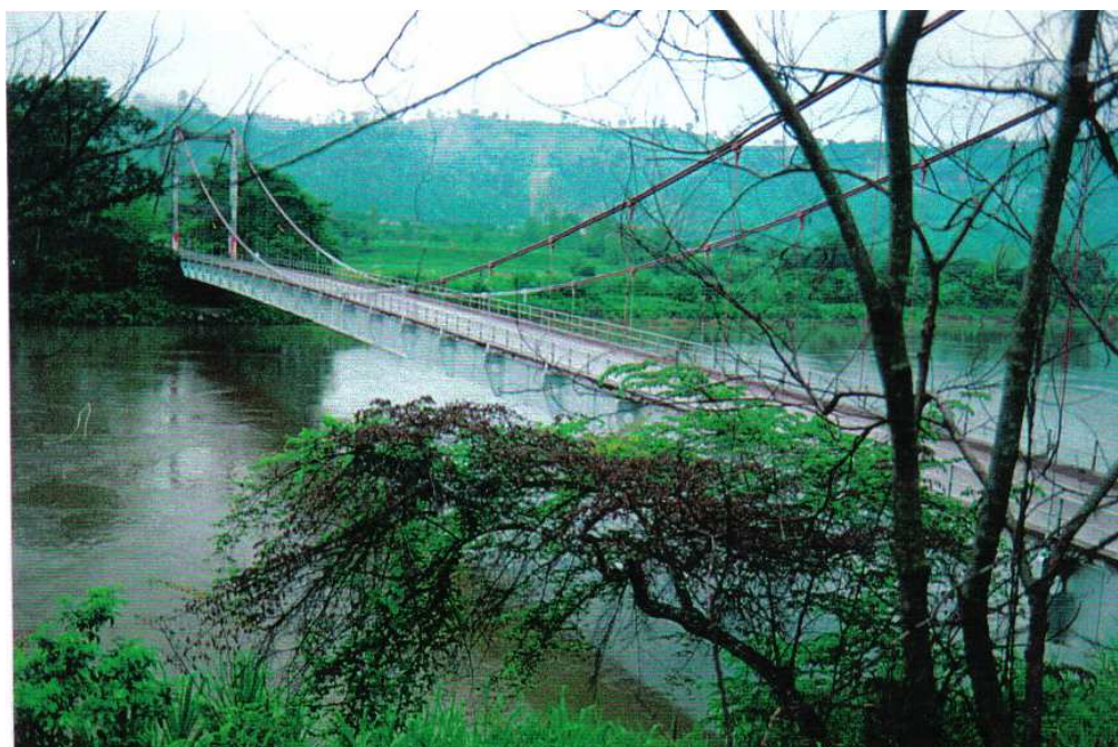
FOTOGRAFÍA N.12.- LATERAL SUPERIOR DEL PUENTE DE TRAMO SAN MATEO- TACHINA SOBRE EL RÍO SAN MATEO
