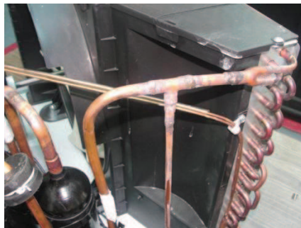
Figura 5.24 Instalación y soldadura para la medición de presión alta en el equipo de pruebas 142
