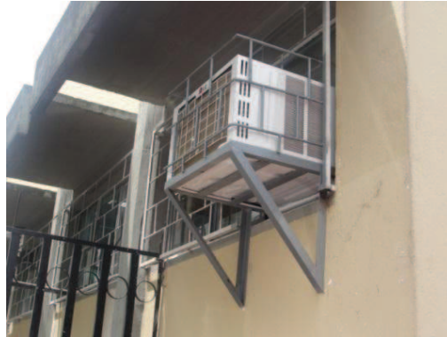
Figura 5.12 Estructura y protección metálica del equipo de pruebas 130
