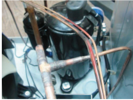
Figura 5.23 Instalación y soldadura para la medición de presión baja en el equipo de pruebas 141
