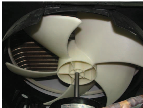
Figura 5.7 Ventilador del equipo de pruebas 125
