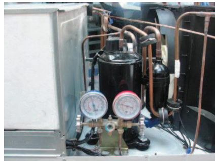
Figura 5.25 Instalación de manómetros (azul: P_{baja} , rojo: P_{alta} ) en el equipo de pruebas 143
