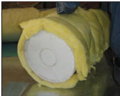
Figura 5. 20 Aislamiento con lana de vidrio del tanque de almacenamiento
