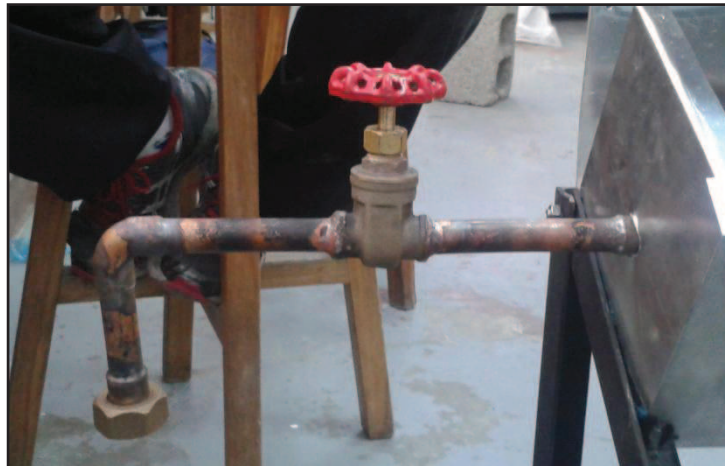
Figura 5. 19 Válvula de compuerta para controlar el flujo de agua
