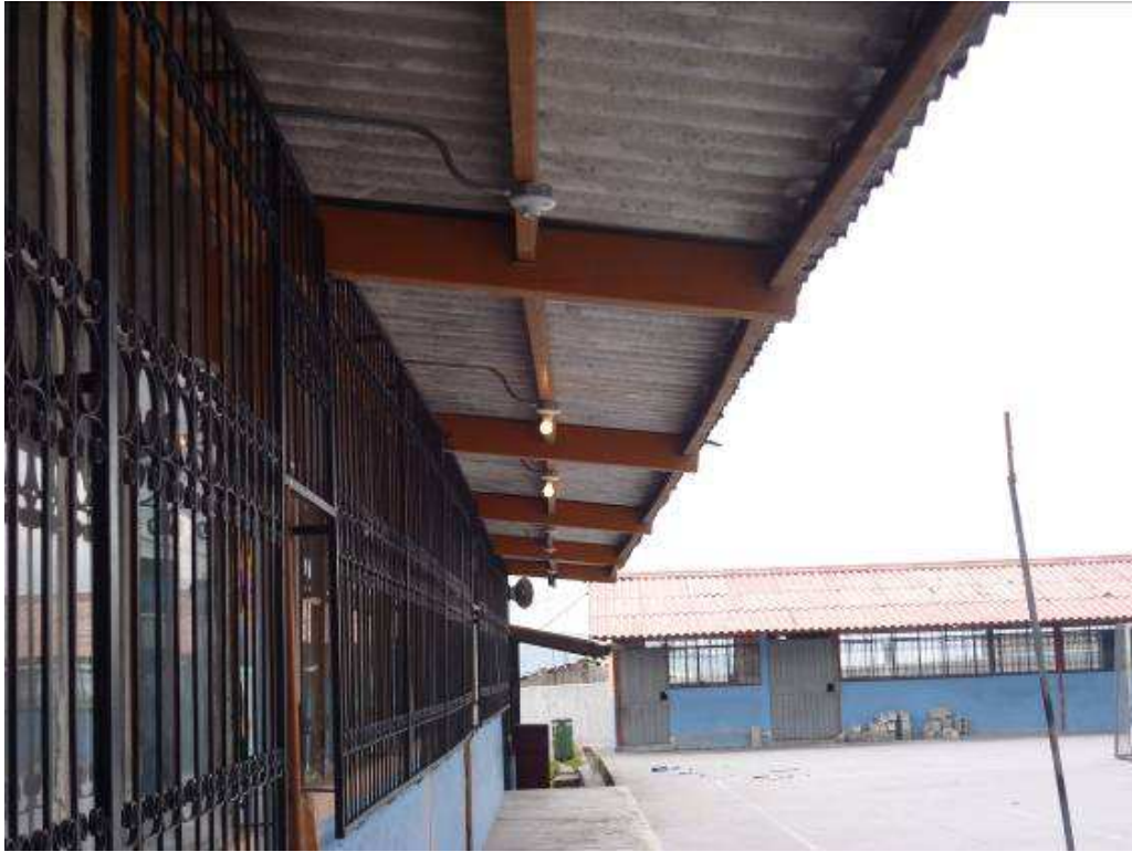
Foto 13. Instalaciones nuevas iluminación corredor aulas 10, 11, 12, 13.
