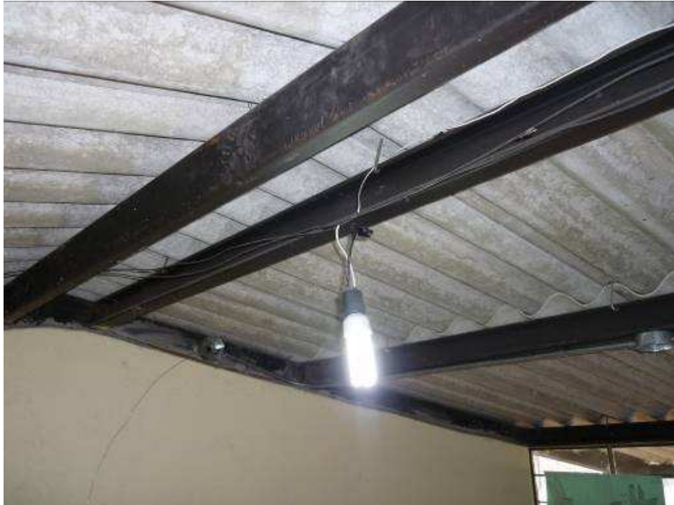
Foto 7. Instalaciones de iluminación antigua, aulas 7, 8, 9.
