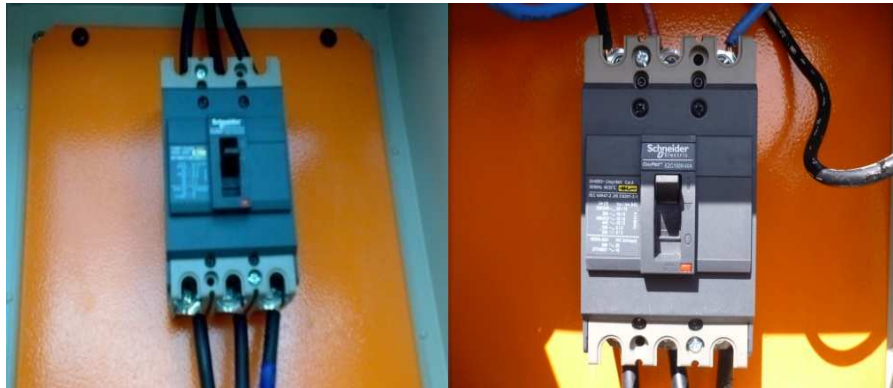
Foto 1. Protección termomagnética actual existente en la Escuela Fiscal Mixta Humberto Vacas Gómez.
