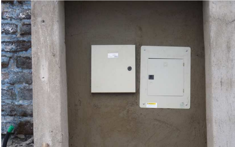
Foto 4. Actual centro de cargas de la “Escuela Fiscal Mixta Humberto Vacas Gómez”
