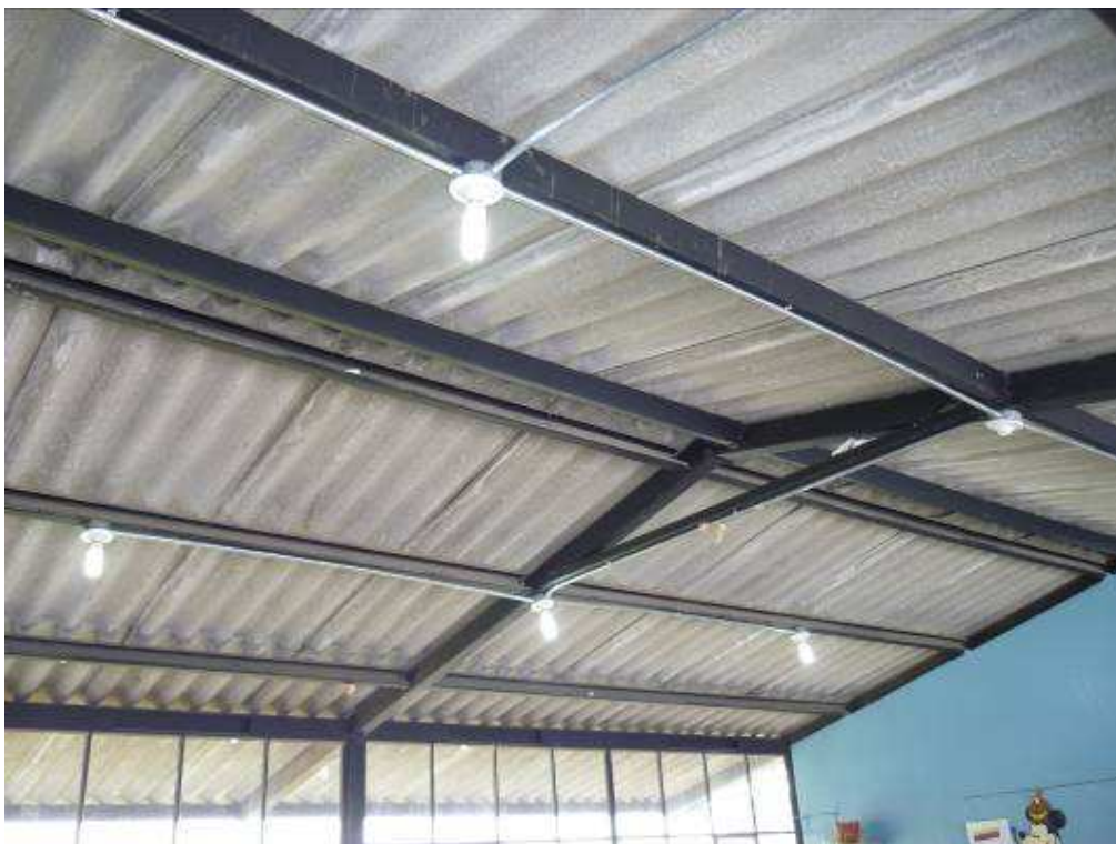
Foto 8. Instalaciones de iluminación nuevas en aulas, aulas 7, 8, 9.
