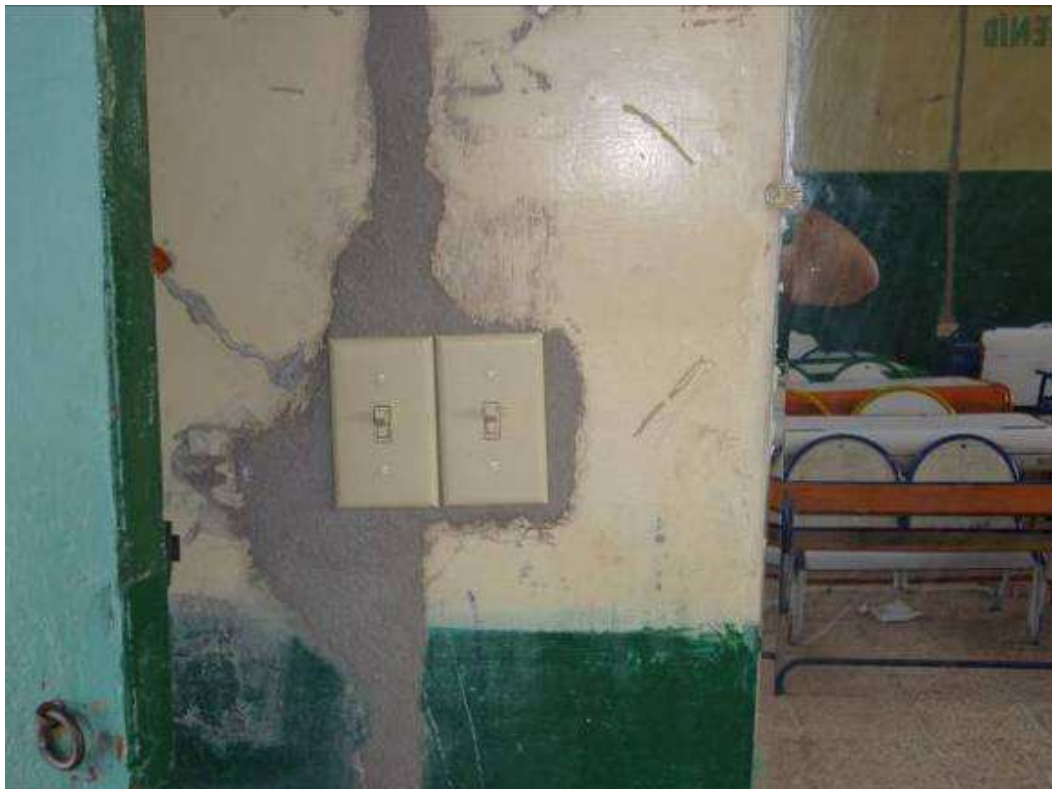
Foto 14. Interruptores nuevos, aulas 10, 11, 12, 13.
