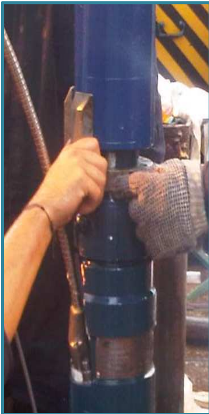
FIGURA 3. 6 MLE CONECTADO AL POTHEAD DEL MOTOR
