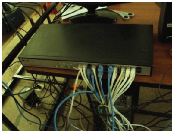
Figura 2.3: Conexión de cableado al Switch de Acceso NEXXT
