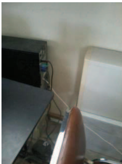
Figura 2.4: Conexión de cableado horizontal a las estaciones de trabajo
