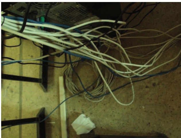
Figura 2.6: Tendido de cableado horizontal sin canaletas
