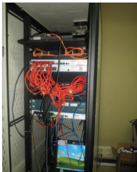
Figura 2. 5 Segmento del cuarto de telecomunicaciones de la DP. MIES-INFA Manabí
