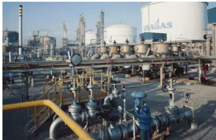
Figura 1.17 Planta de hidrocarburos
