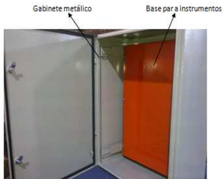
Figura 4.1 Gabinete metálico con doble fondo
