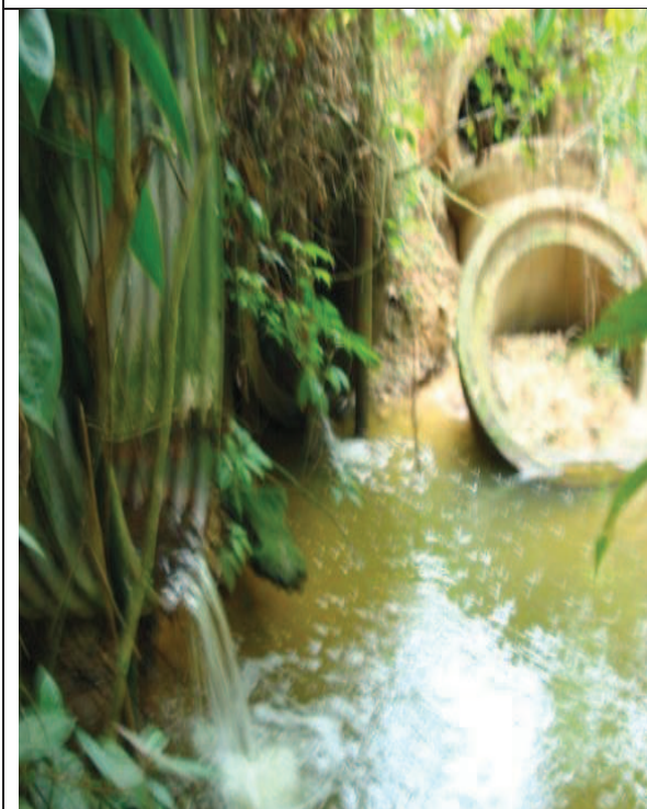
Foto No. 3.- Descarga de aguas industriales y negras y grises – Bloque 16
