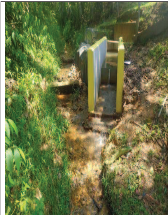
Foto No. 1.- Descarga de aguas negras y grises del Campamento SPF – Bloque 16
