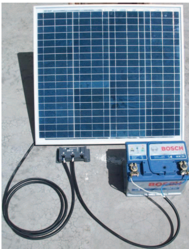
Figura 2.10. Dispositivos del sistema fotovoltaico
