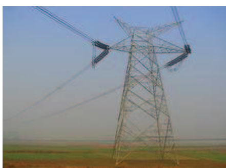
Figura 2.11 Línea de transmisión dc de alto voltaje.
