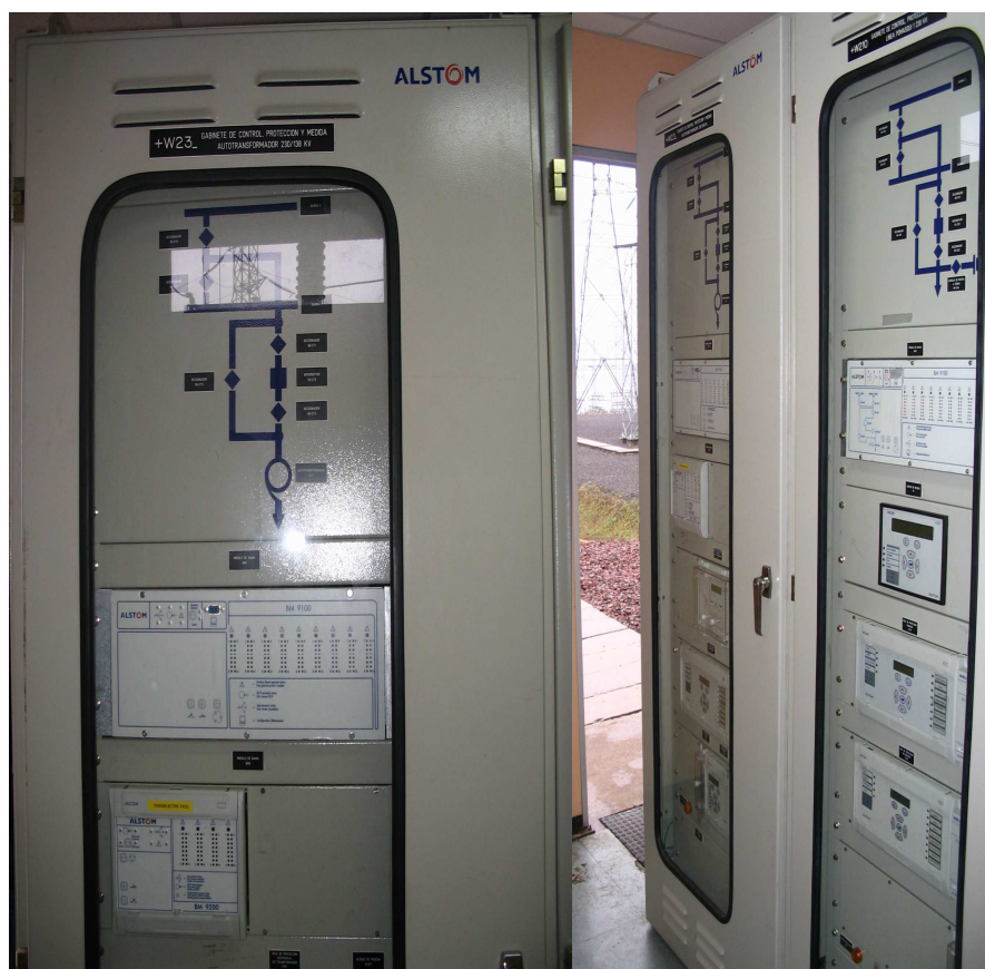
Fig.12 Tablero de control distribuido
