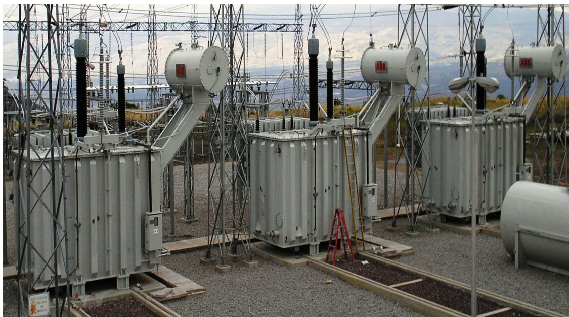
Fig.2 Banco de autotransformadores ATT
