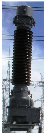
Fig.5 Transformador de Corriente
