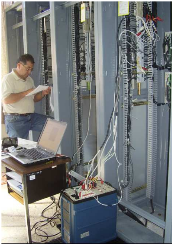
Fig.24 Cableado de señales del disparo de los diferentes relés.
