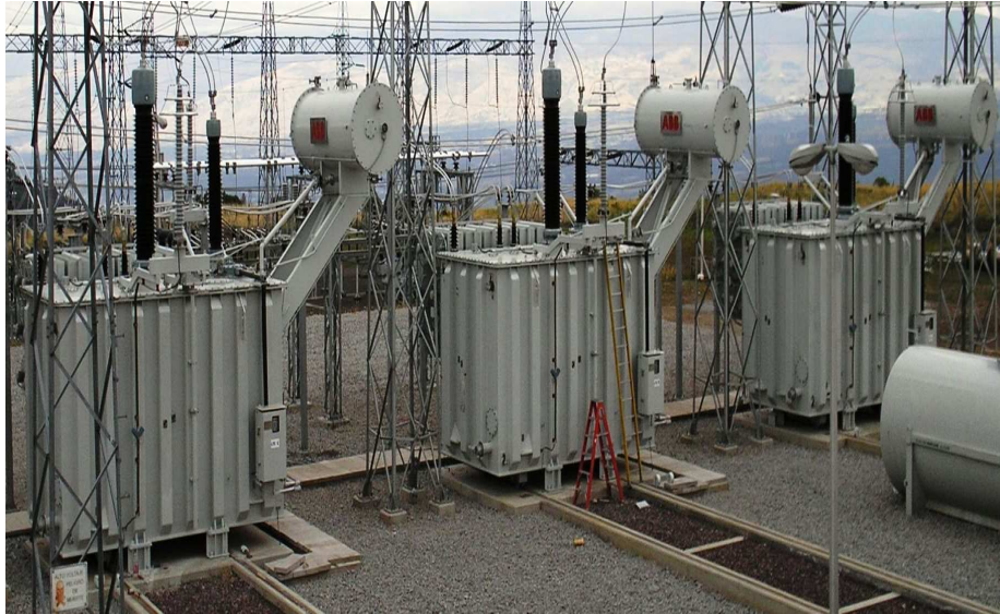
Fig.4 Banco de autotransformador
