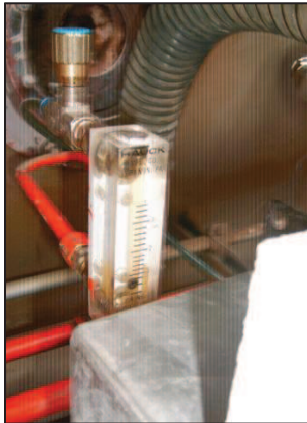
Figura 3.7. Manómetro ubicado a la entrada del quemador
