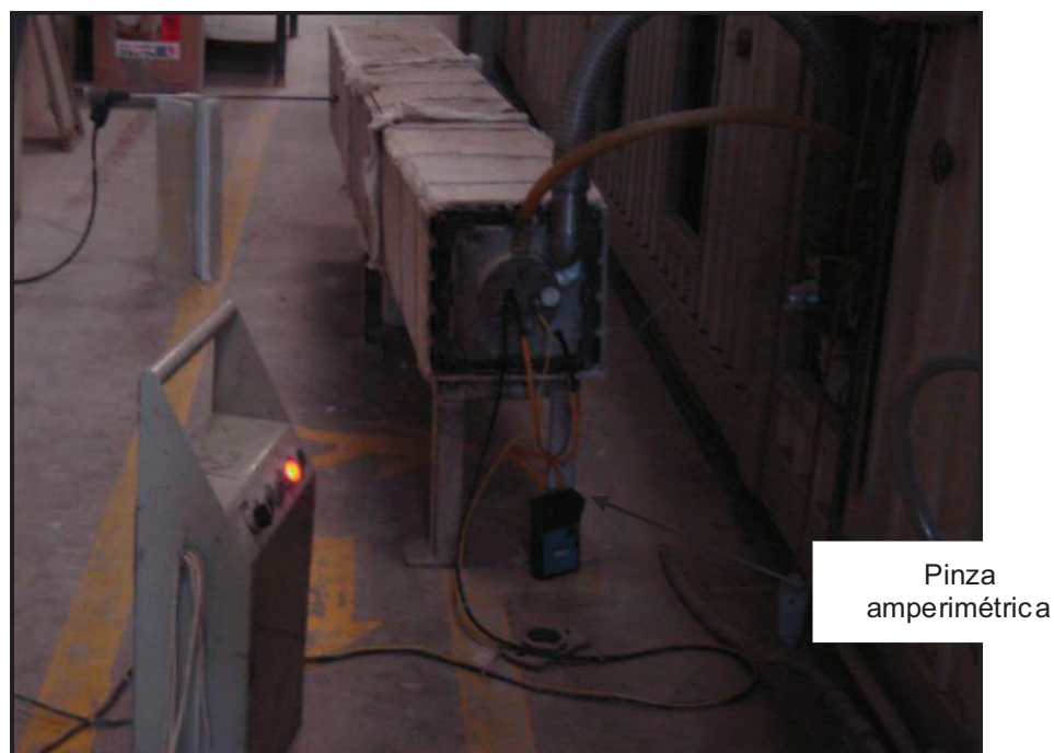
Figura 3.13. Pinza amperimétrica conectada a la entrada del quemador
