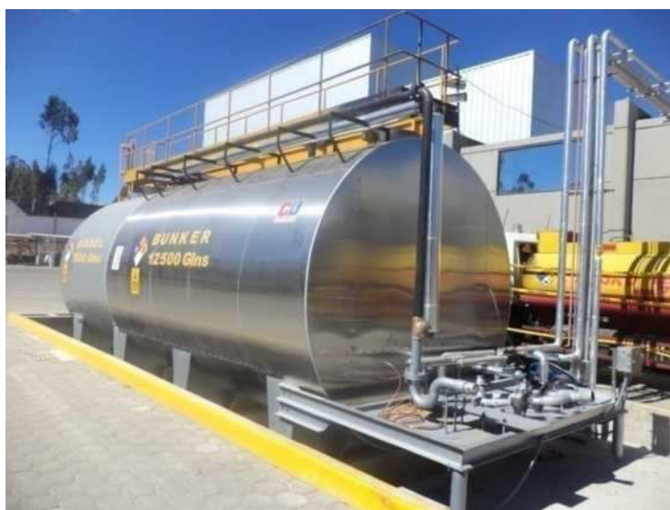
Figura N° 3.1 Tanque de almacenamiento de combustibles
