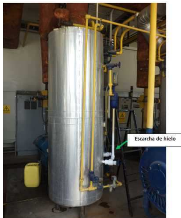
Figura N° 3.13 Escarcha de hielo formado en la tubería de las válvulas de nivel del vaporizador SNAM3000
