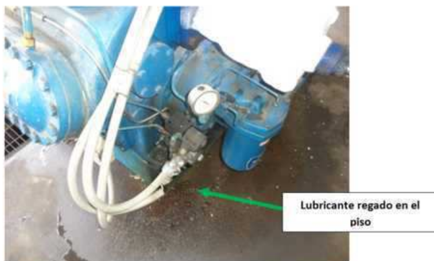
Figura N° 3.7 Lubricante que se desperdicia en el compresor SNCM1000
