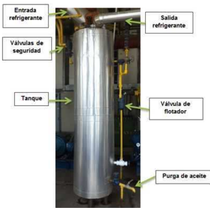
Figura N° 2.12 Partes del vaporizador de D= 16 pulgadas marca Vilter.
