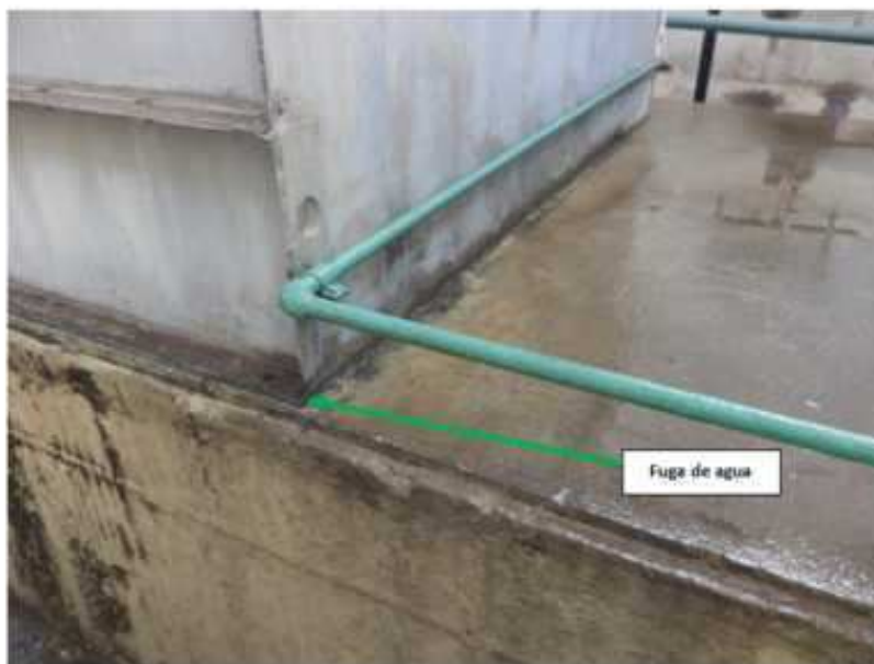
Figura N° 3.10 Daño encontrado en el condensador evaporativo SNCN2000
