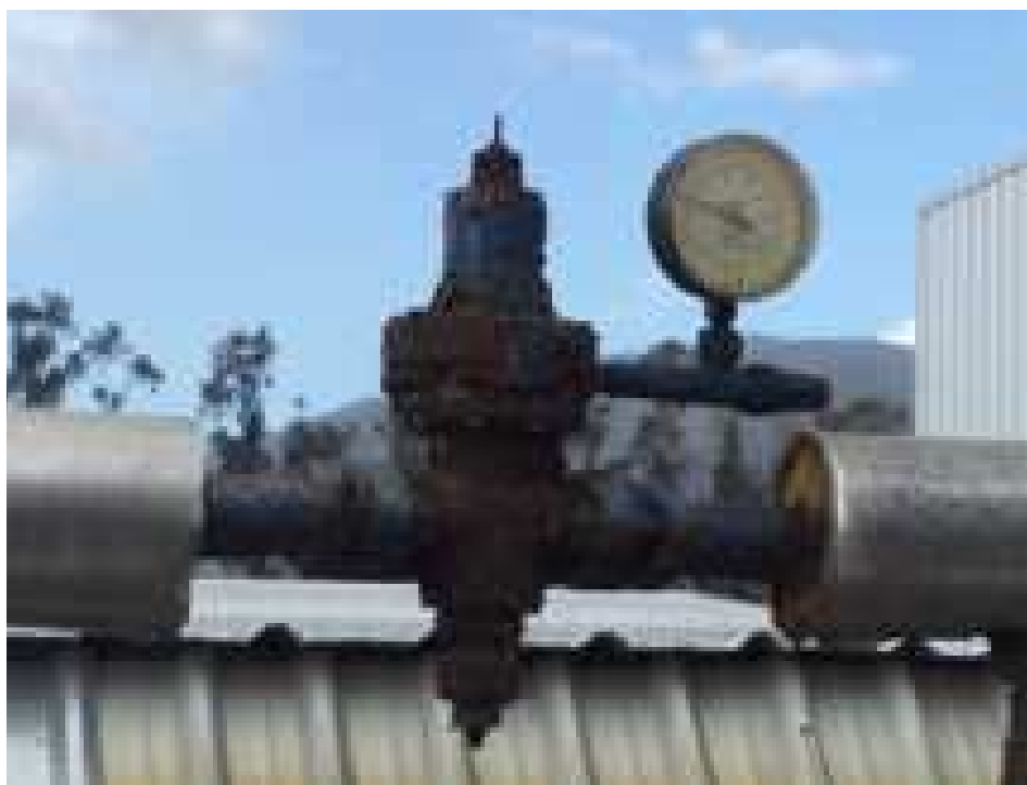
Figura N° 3.11 Válvula reguladora de presión deteriorada tubería de succión sector de elaboración.
