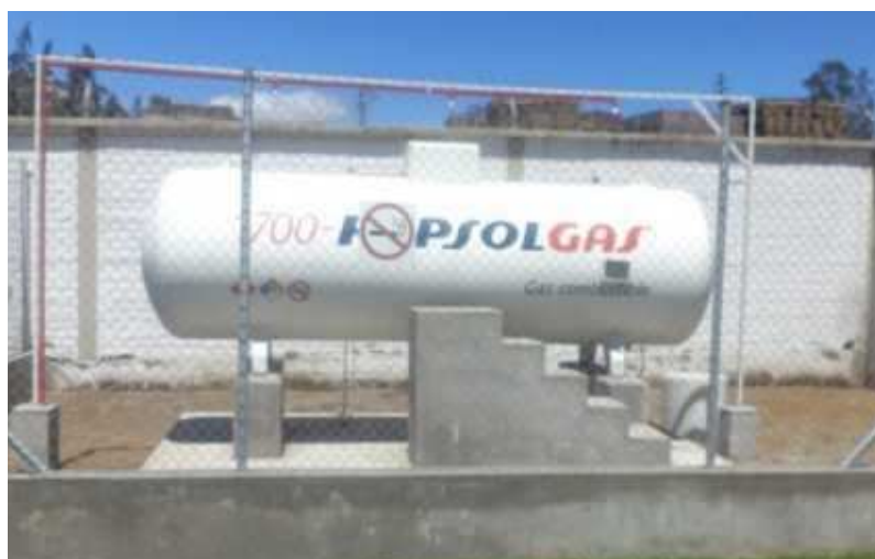
Figura N° 3.2 Recipiente de almacenamiento de G.L.P.
