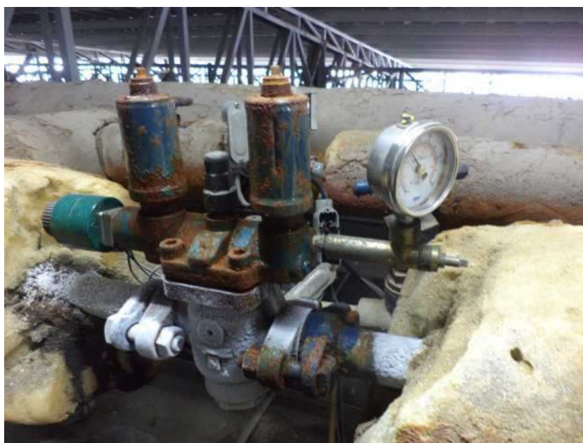
Figura N° 3.12 Válvula reguladora de presión deteriorada
