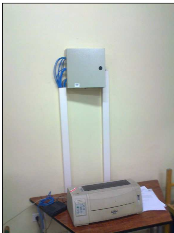
Figura N. 4.14:Rack empotrado en la pared Fuente: Realización In Situ, Darwin Fernando Adriano
