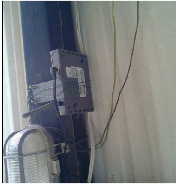
Figura N. 4.16: Instalación del • AP D-LINK DWL-2100AP Fuente: Realización In Situ, Darwin Fernando Adriano
