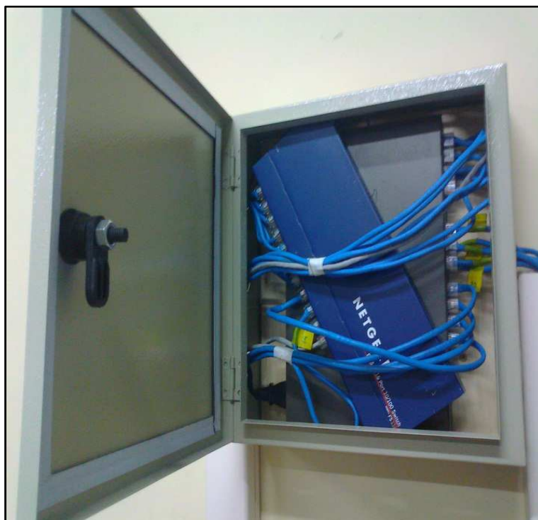
Figura N. 4.13:NETGEAR WGR614- D-LINK DES-1008D Instalado Fuente: Realización In Situ, Darwin Fernando Adriano
