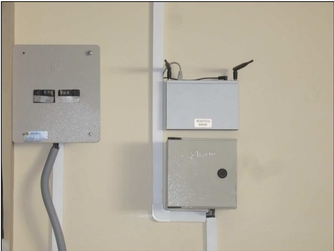
Figura N. 4.12: FORTIWIFI-30V Instalado Fuente: Realización In Situ, Darwin Fernando Adriano
