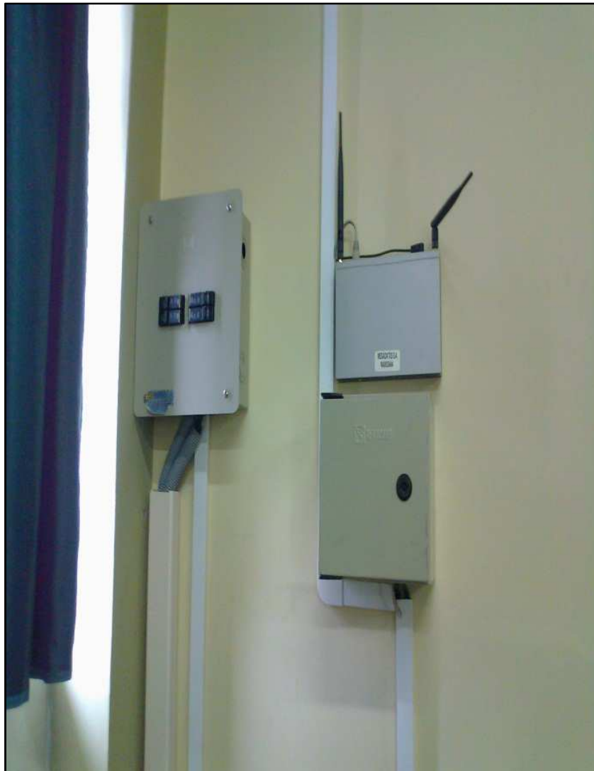
Figura N. 4.18: Disposición de las canaletas Fuente: Realización In Situ, Darwin Fernando Adriano
