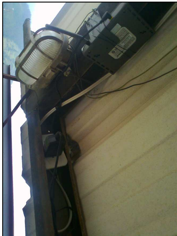
Figura N. 4.17: Instalación del • AP D-LINK DWL-2100AP Fuente: Realización In Situ, Darwin Fernando Adriano
