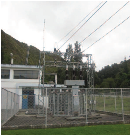
Figura 1.7 Patio de Transformación Central Hidroeléctrica Illuchi 2
