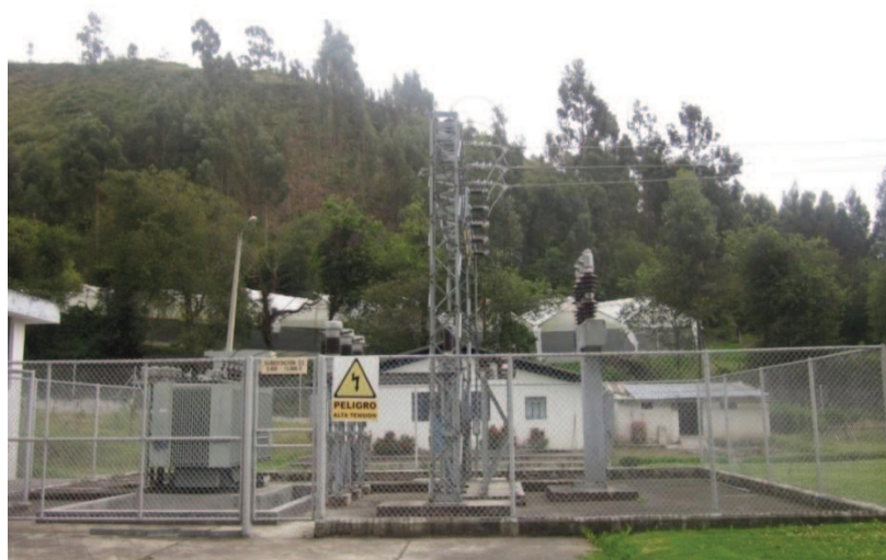
Figura 1.10 Vista Transformador Elevador Central Hidroeléctrica Illuchi 2
