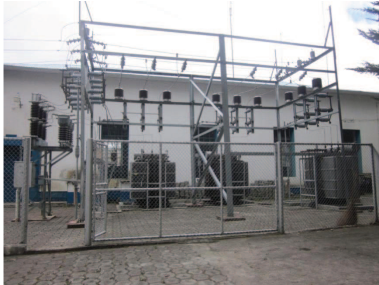
Figura 1.6 Vista de los 3 Transformadores de la Central Hidroeléctrica Illuchi 1
