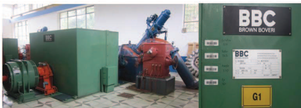
Figura 1.9 Grupo Generador 1 Central Hidroeléctrica Illuchi 2
