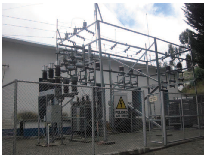
Figura 1.3 Patio de Transformación Central Hidroeléctrica Illuchi 1
