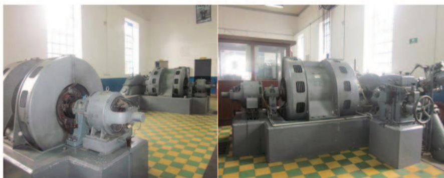
Figura 1.5 Grupos Generadores de la Central Hidroeléctrica Illuchi 1
