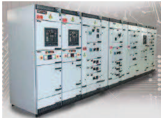
Figura 2.25 Equipo Eléctrico de Protección y Maniobra
