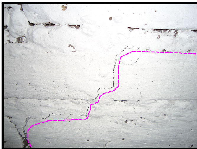
Figura 7-14: Fisura A-A producida con la carga correspondiente al 70% del peso propio (4.40 Ton) sentido P2
