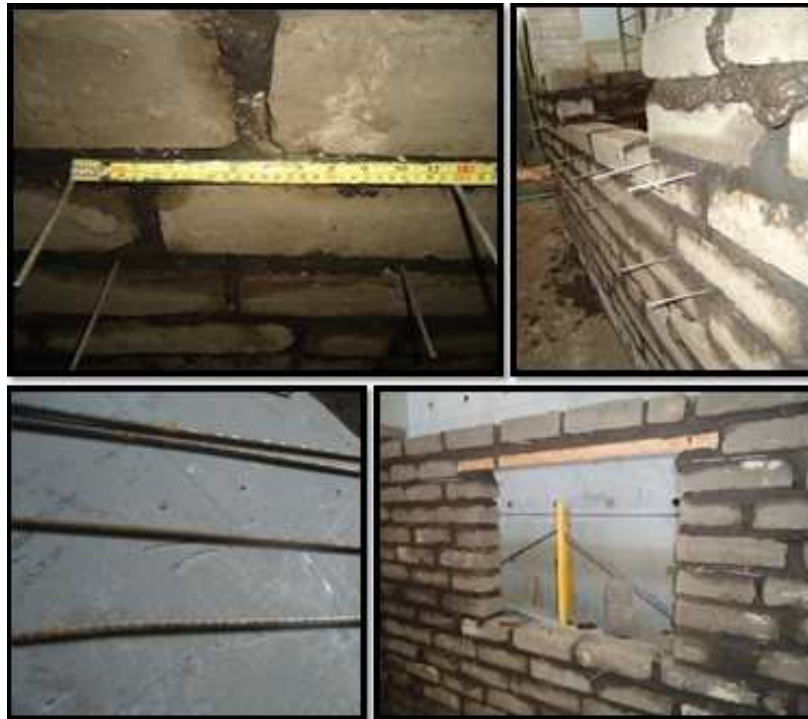
Figura 5-18: Ubicación de los conectores para la malla en la zona de la ventana
