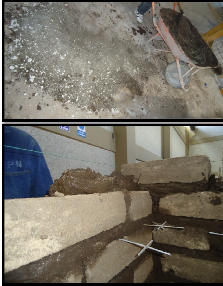
Figura 5-19: Mezcla a base de arena y cemento para pegar la última hilera del prototipo
