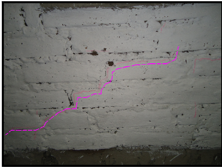
Figura 7-17: Fisura B-B con la carga correspondiente al 70% del peso propio (4.40 Ton) sentido P2
