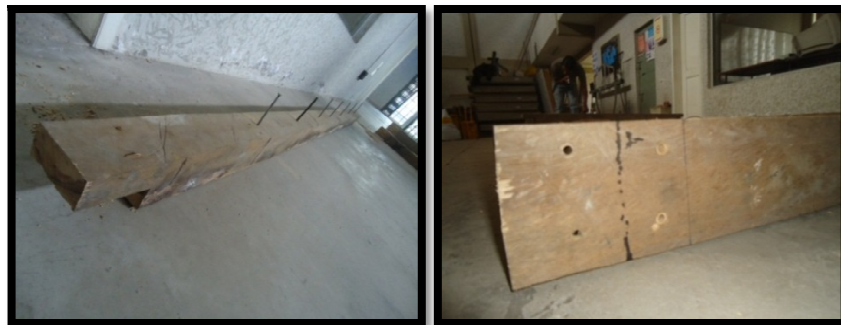
Figura 5-23: Colocación de clavos tirafondos para el anclaje de las vigas con la pared y perforación en los destajes
