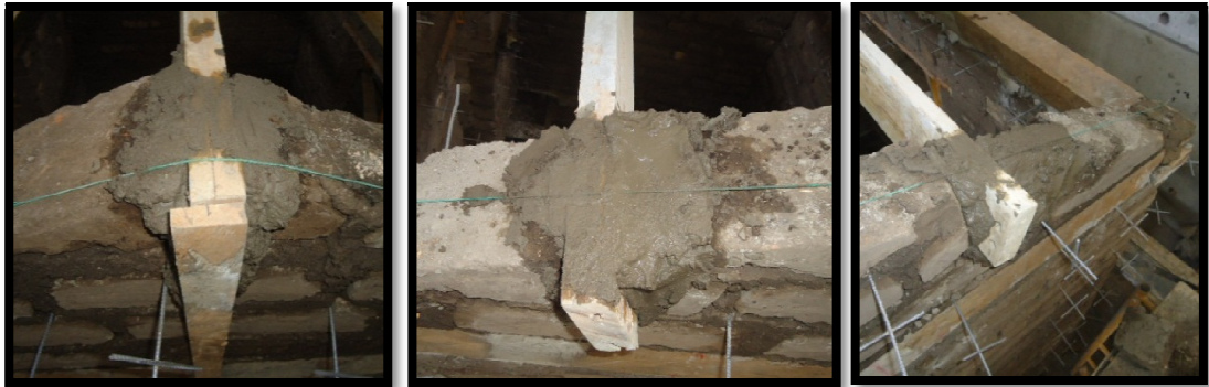
Figura 5-30: Ubicación de los tirafondos para garantizar el no deslizamiento de las correas
