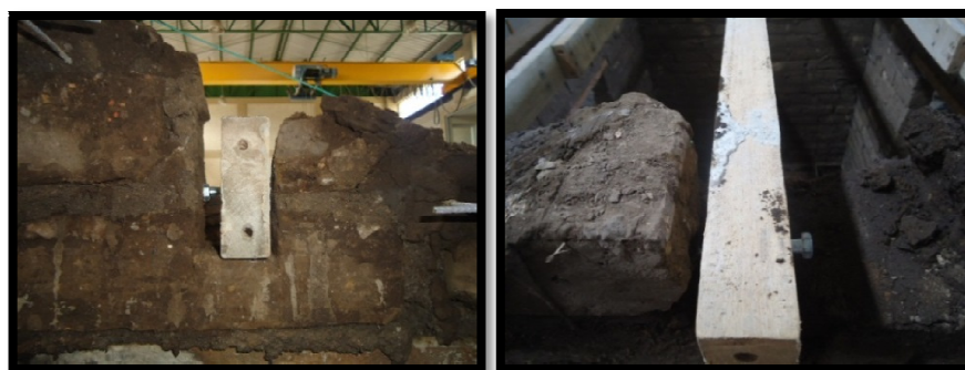
Figura 5-29: Ubicación de los tirafondos para garantizar el no deslizamiento de las correas
