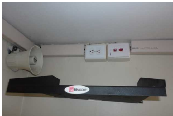
Figura 3-13: Ubicación del Switch en el antiguo laboratorio de electrónica
