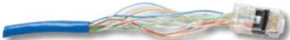
Figura 7: La imagen muestra un primer plano de la terminación del par en un extremo del latiguillo de 2 metros. Este es el fallo en el enlace probado.
