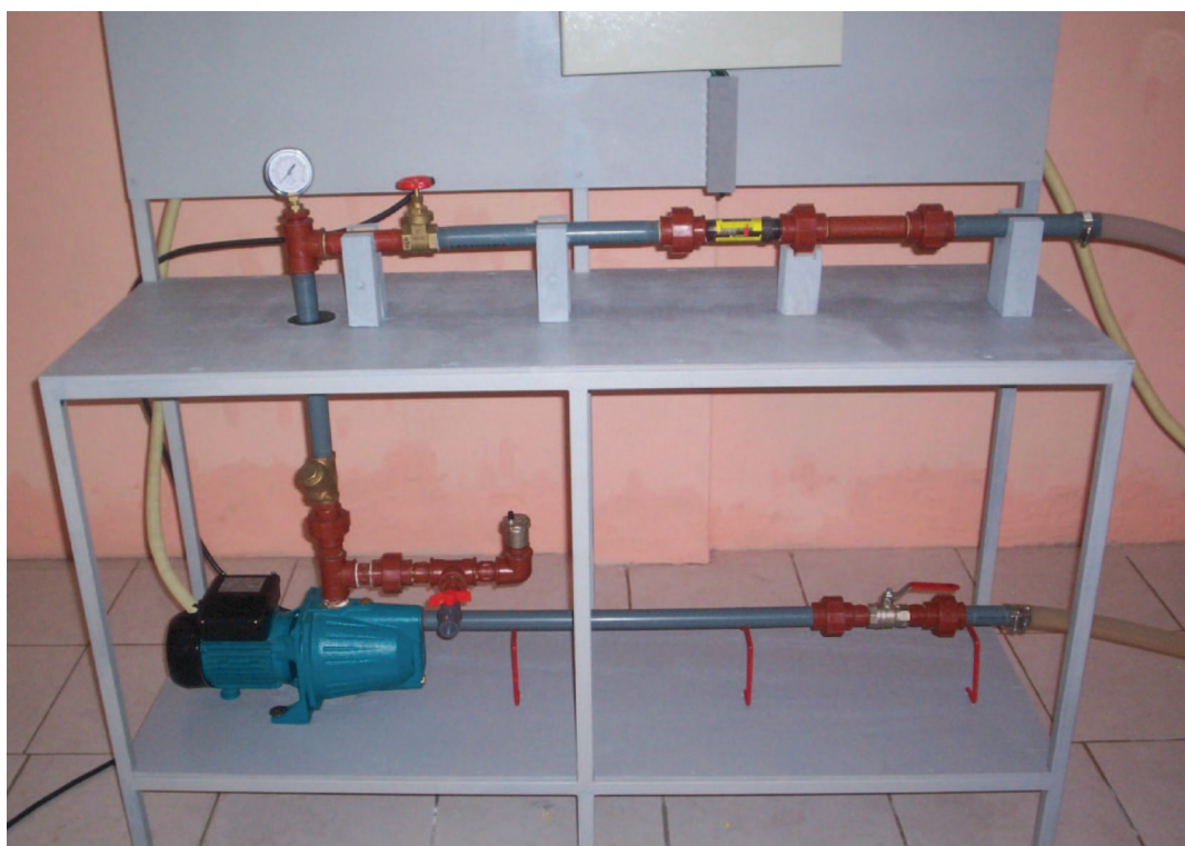
Figura 3.18 Imágenes del banco de pruebas para bombas JET
