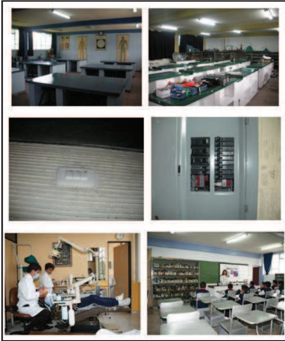
Foto 2.28.: Instalaciones Eléctricas del Bloque Nuevo y Centro Medico
