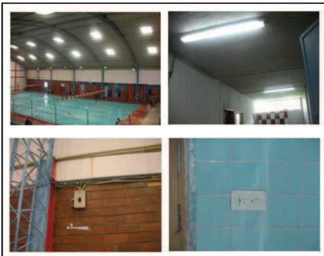
Foto 2.26.: Estado Actual de las Instalaciones Eléctricas de la Piscina.
