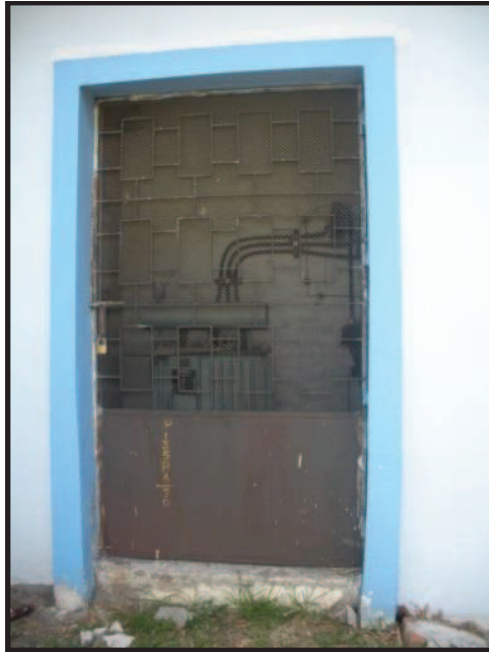
Foto 2.1.: Cámara de transformación dentro de la institución.
