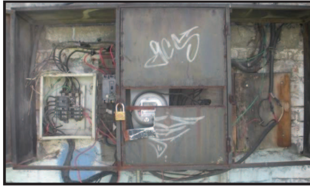
Foto 2.7.: Estructura Física del Contador de Energía.
