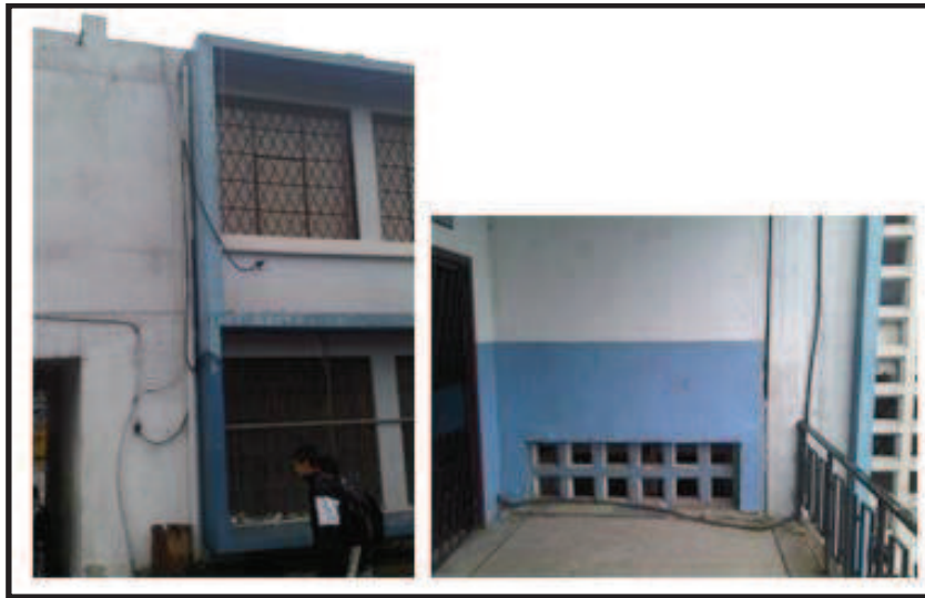
Foto 2.12.: Conductores y Tuberías Conduit a la Intemperie
