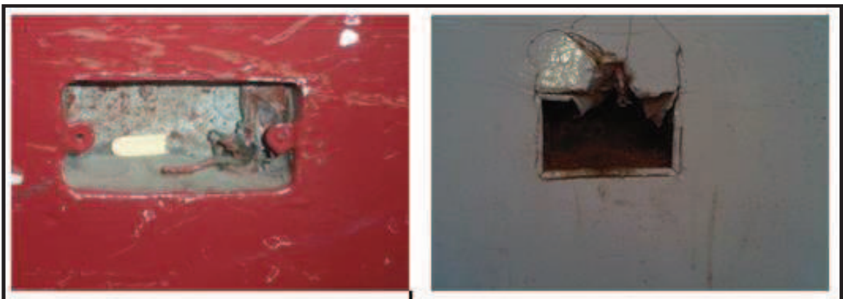
Foto 2.19.: Estado Actual de Los Tomacorrientes en la Institución.
