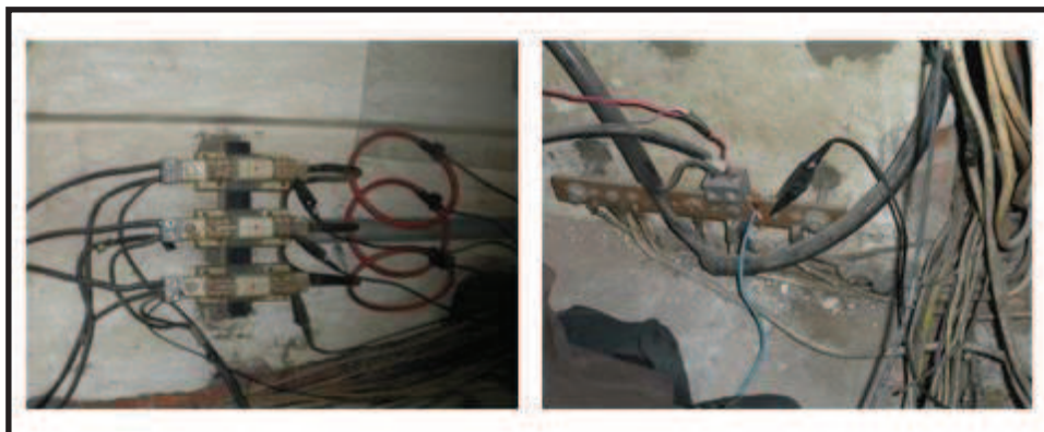
Figura 2.30.: Instalación del Analizador Industrial Fluke 1735
