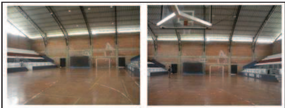
Foto 2.25.: Estado Actual de las Luminarias en el Coliseo
