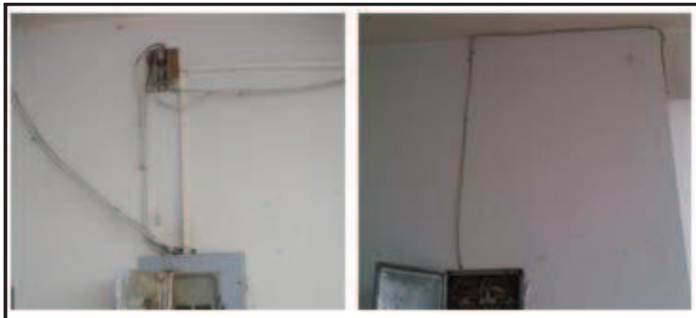
Foto 2.13.: Circuitos Improvisados de Iluminación y de Fuerza.
