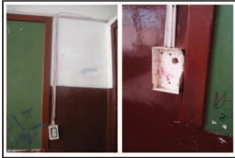
Foto 2.20.: Estado Actual de Los Tomacorrientes en Aulas.
