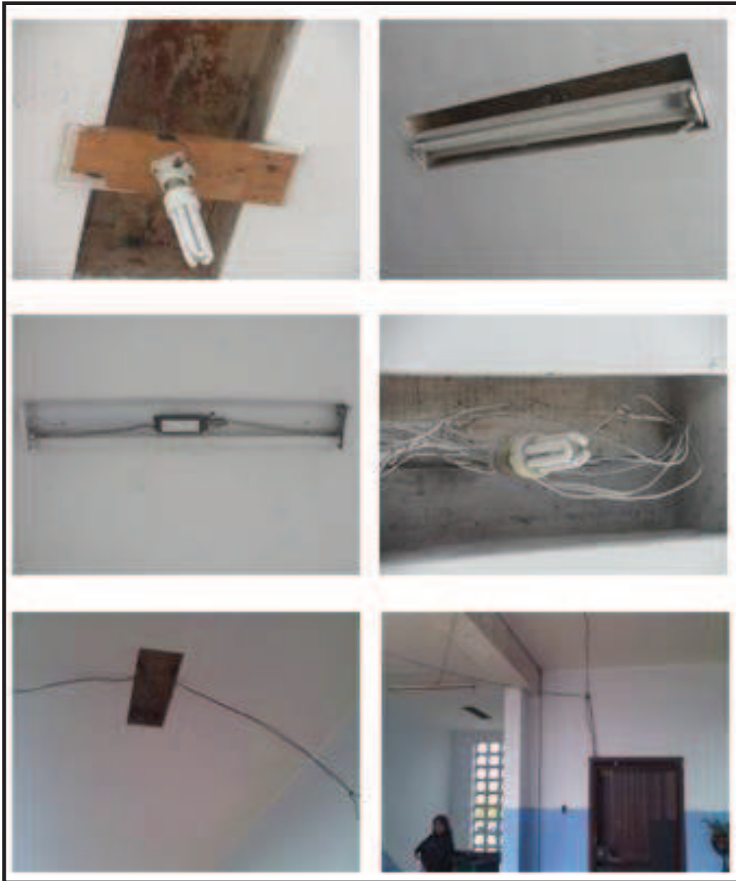
Foto 2.17.: Estado Actual de las Luminarias en los Pasillos.
