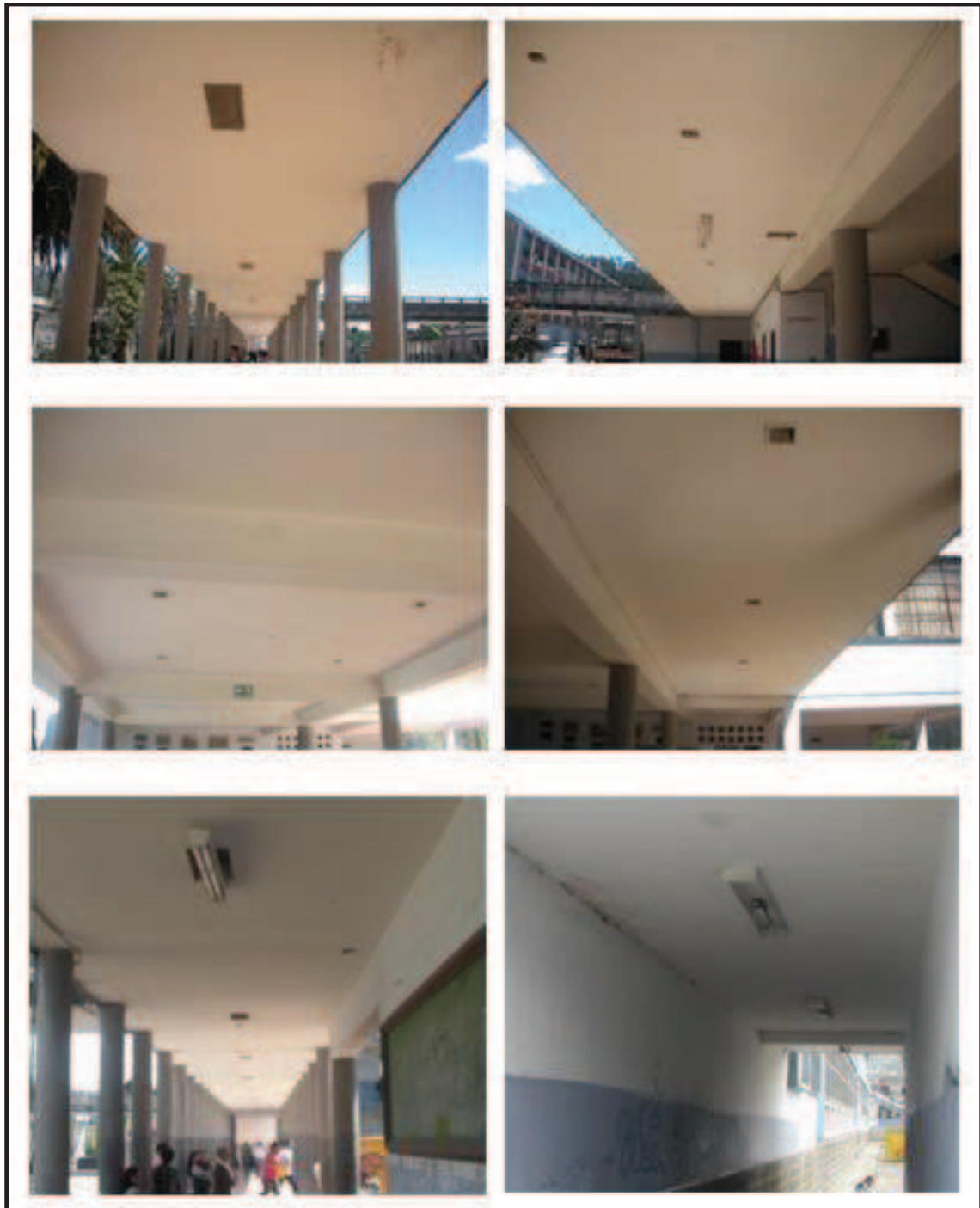
Foto 2.16.: Estado Actual de Iluminación en los Pasillos.
