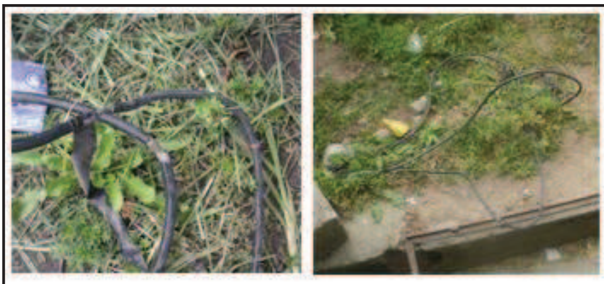
Foto 2.14.: Cables deteriorados por factor humano.
