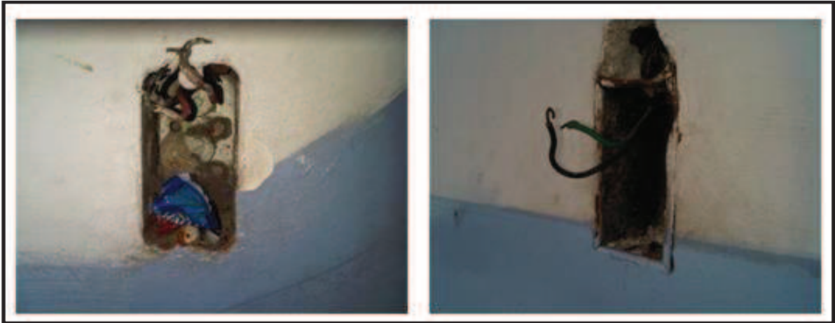
Foto 2.18.: Estado Actual de Los Interruptores en los Pasillos.
