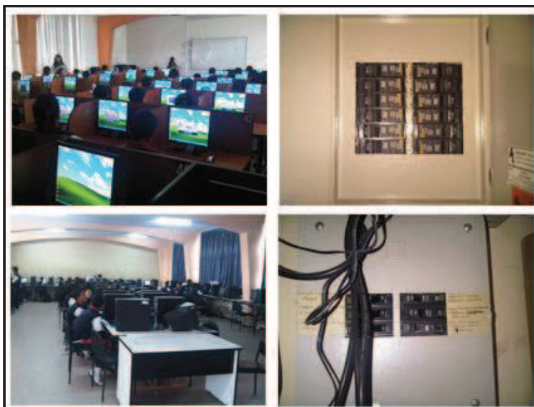
Foto 2.27.: Estado Actual de las Instalaciones Eléctricas de Centros de Cómputo y Laboratorio de Idiomas.
