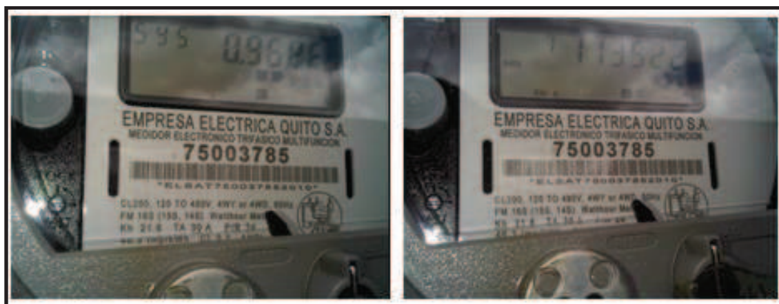
Foto 2.6.: Contador de Energía Eléctrica Actual.
