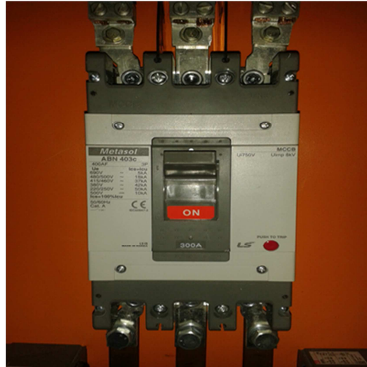
Figura 5.6.- Fotografía del breaker de 300 [A] de marca LS.
