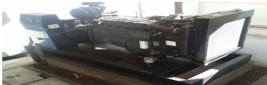
Figura 5.5.- Fotografía del grupo eléctrico LOVATO RGK-60 de 125 KW.
