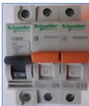
Figura 2.25 Breakers para Bomba y Elementos de control
