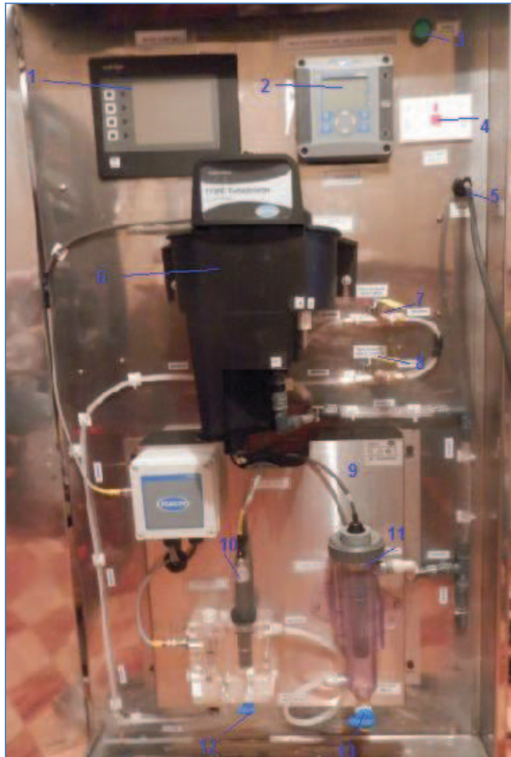
Figura 5. Elementos del Tablero de Agua Potable
