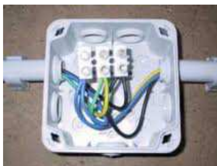
Figura 4.3 Punto de empalme
