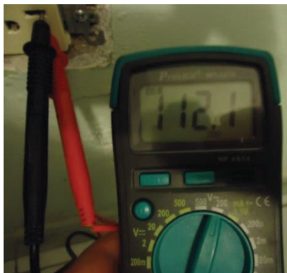
Figura 4.2 Medición de voltaje de puntos eléctricos
