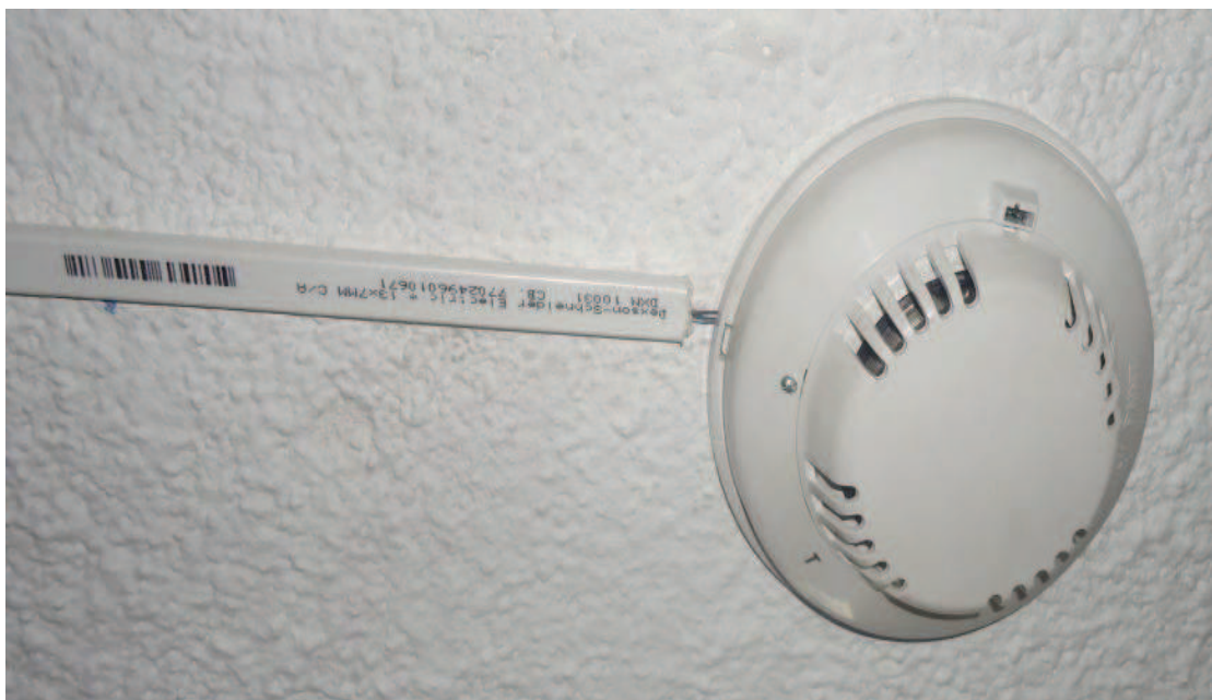
Figura 3.36 Fotografía de sensor de humo instalado
