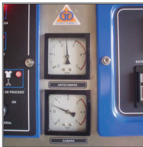
Figura 2.11 Manómetros de Cámara y Antecámara
