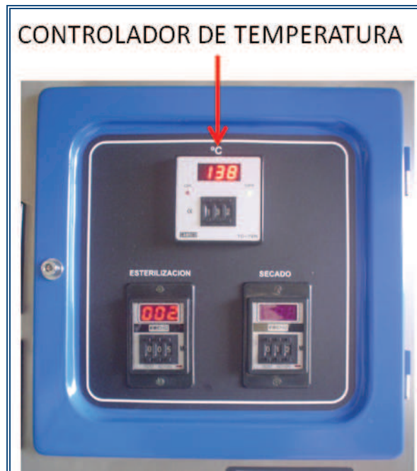
Figura 2.13 b) Controlador de temperatura Camsco TC-72N en panel de control
