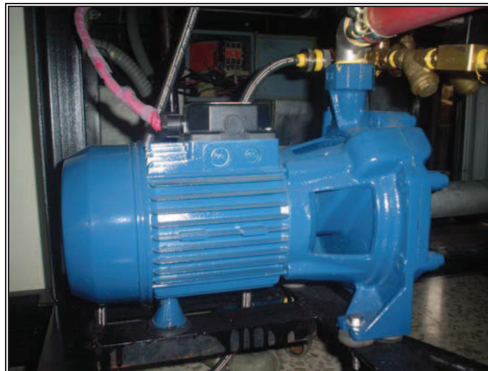
Figura 2.16 Bomba Centrífuga de marca Pedrollo.
