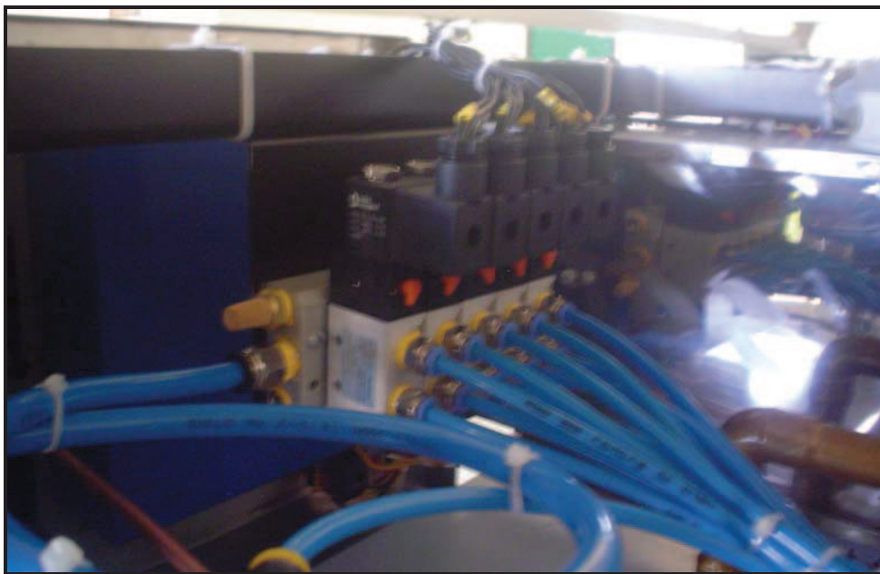
Figura 2.8 Electroválvulas ubicadas sobre la cámara
