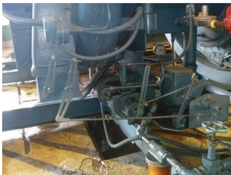
Acoplamiento mecánico regulación de combustión
