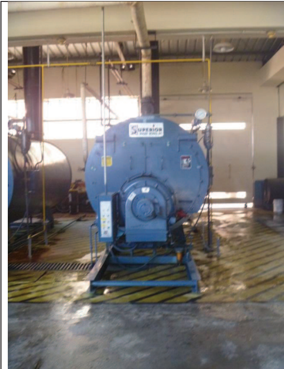
Caldero N° 03 Hospital IESS-Ambato
