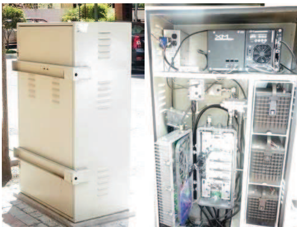
Figura 1.15 Gabinete para Nodo Óptico y Fuente Alpha (90x140cm) interior y exterior
