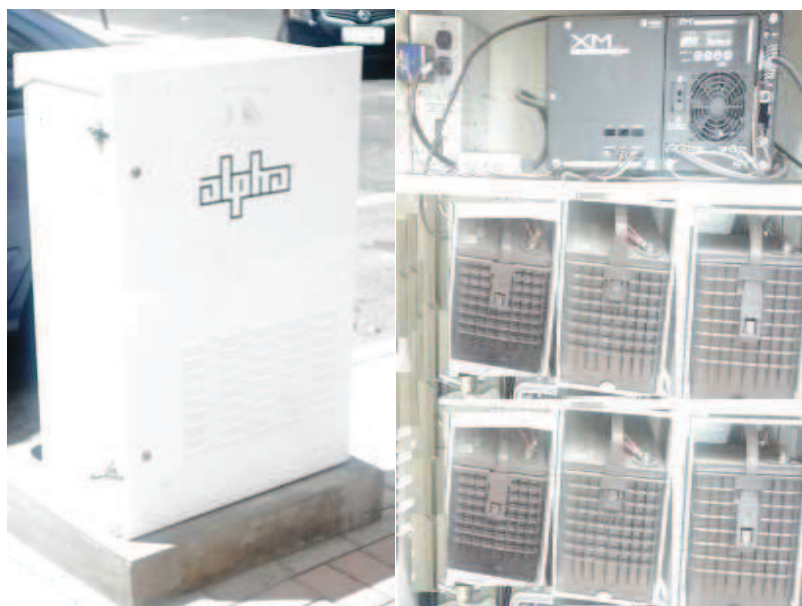
Figura 1.17: Gabinete para Fuente Alpha XM-2 y Banco de Baterías (70x100cm) interior y exterior
