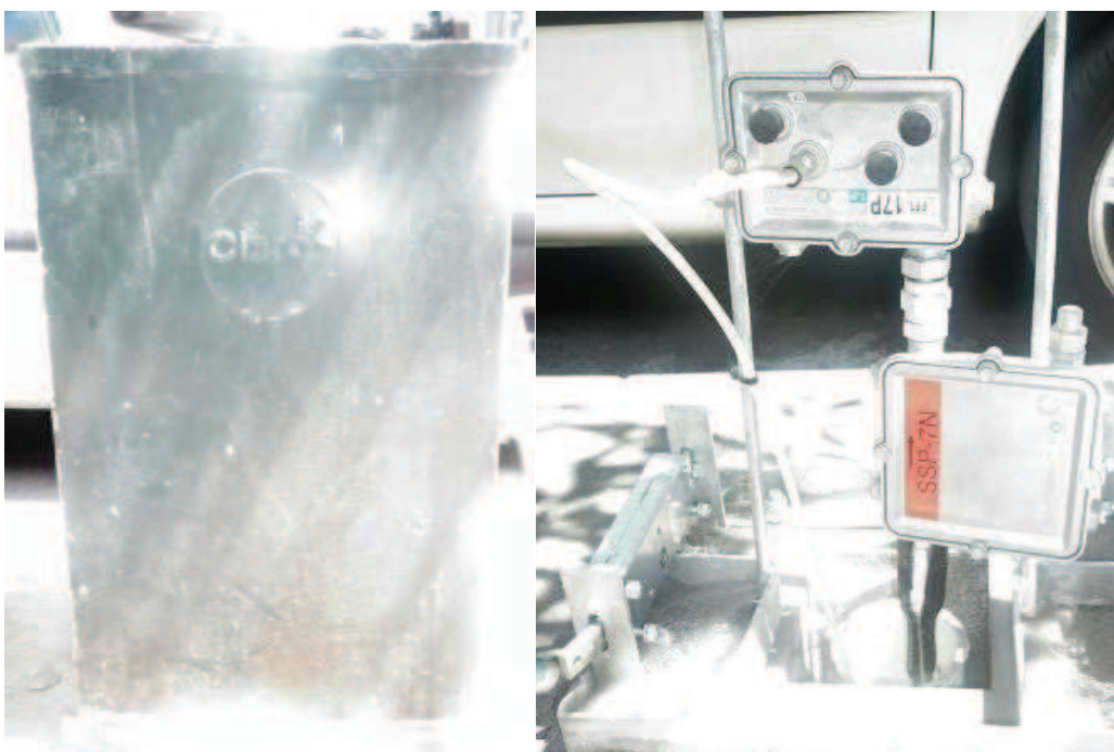
Figura 1.18: Gabinete para Taps y Acopladores de red (40x60cm) interior y exterior
